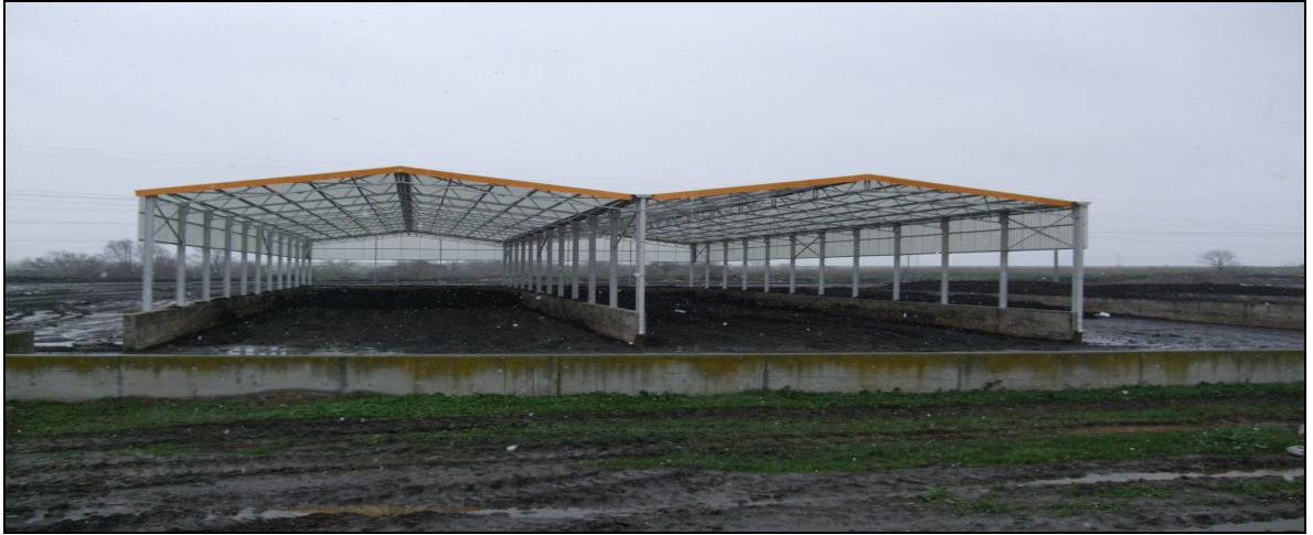
Şekil 5.2. Merkezi atıksu arıtma tesisi çamur keki depolama sahası
