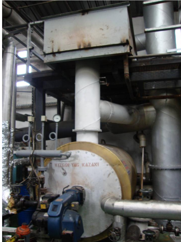
Resim 4.1. Mevcut Tesiste Fuel-Oil Yakıtlı Kazan
