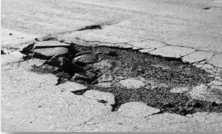
Şekil 4.4. Ayrışma nedeniyle oluşan yüksek şiddette bir çukur
