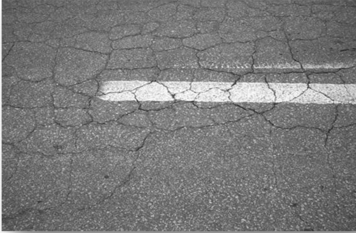
Şekil 4.5. Esnek yol kaplamalarında timsah sırtı çatlaklara ait bir görünüş
