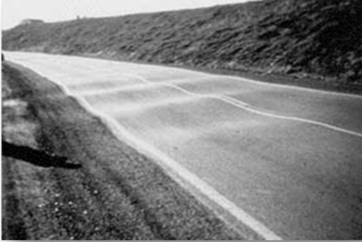
Şekil 4.3. Esnek yol kaplamalarında ondülasyona ait bir görünüş
