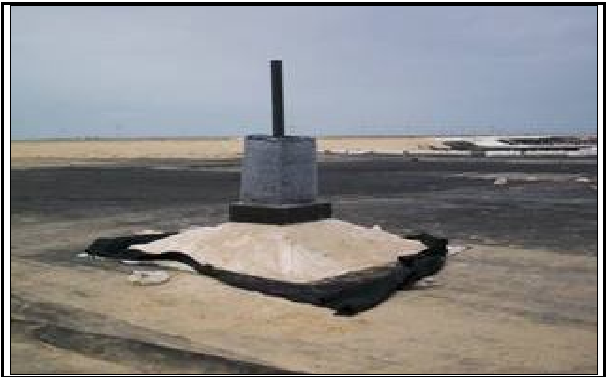
Şekil 2.17. Düzenli depolama sahası gaz bacası örneği (Anonim 2009 c)
