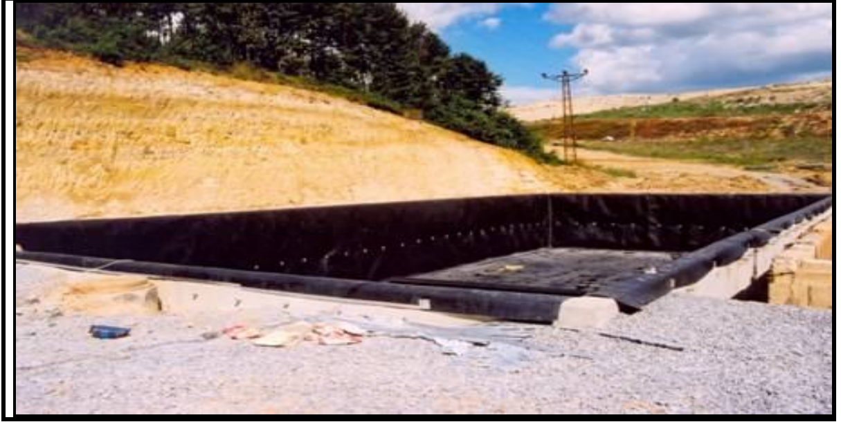
Şekil 2.18. Düzenli depolama sahası sızıntı suyu havuzu (Anonim 2009 c)
