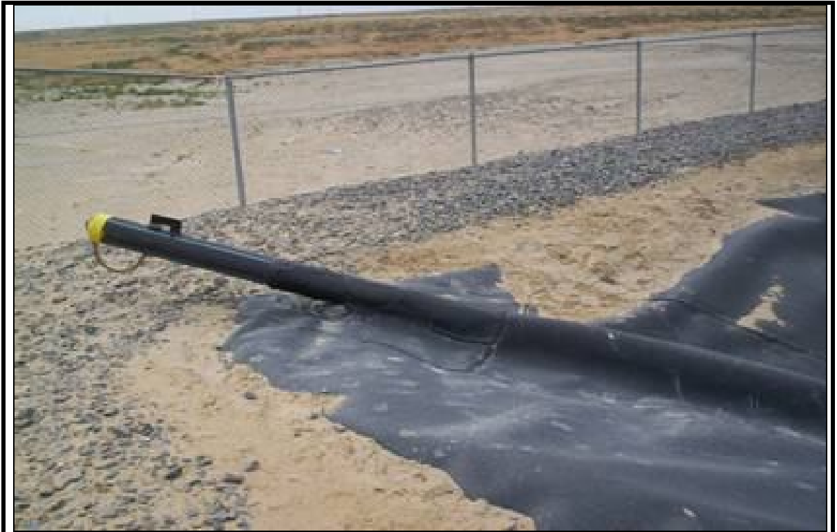
Şekil 2.15.. Sızıntı Suyu Toplama sistemi (Anonim 2009 c).
