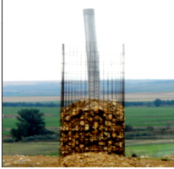
Şekil 5.4a-b. Katı atık alanındaki gaz toplama bacası (Özgün)
