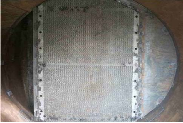
Şekil 2. Reaktör Tabanındaki Izgara (Grid on Reactor Base)
