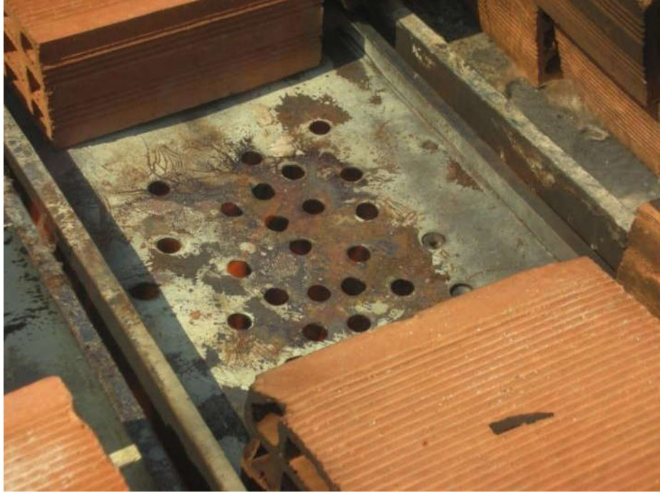
Şekil 3.4. Yangın odasından atık gaz çıkışını sağlamak için saç levha üzerine açılan delikler
