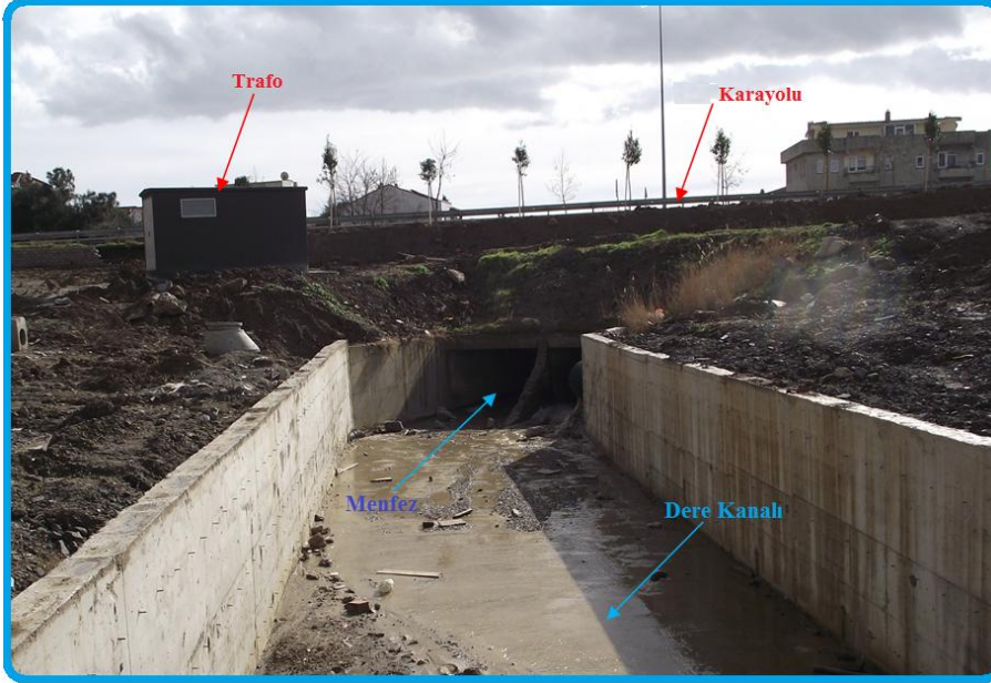
Şekil 4.76. Aydınpinar deresinde taşkın riskine maruz kalabilecek bir trafo ve yol
