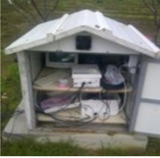
Şekil 3.4. Kontrol ünitesi ve muhafaza kulübesi
