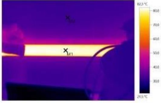
Şekil 4.8. Termal kamera görüntüsü-sıcak su hattı
