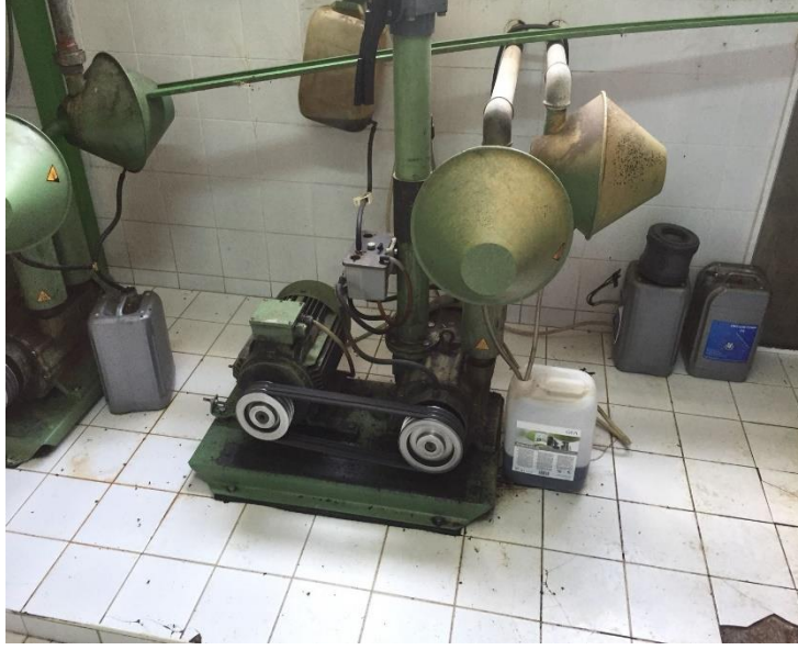
Şekil 3.5. İşletmede kullanılan vakum pompası
