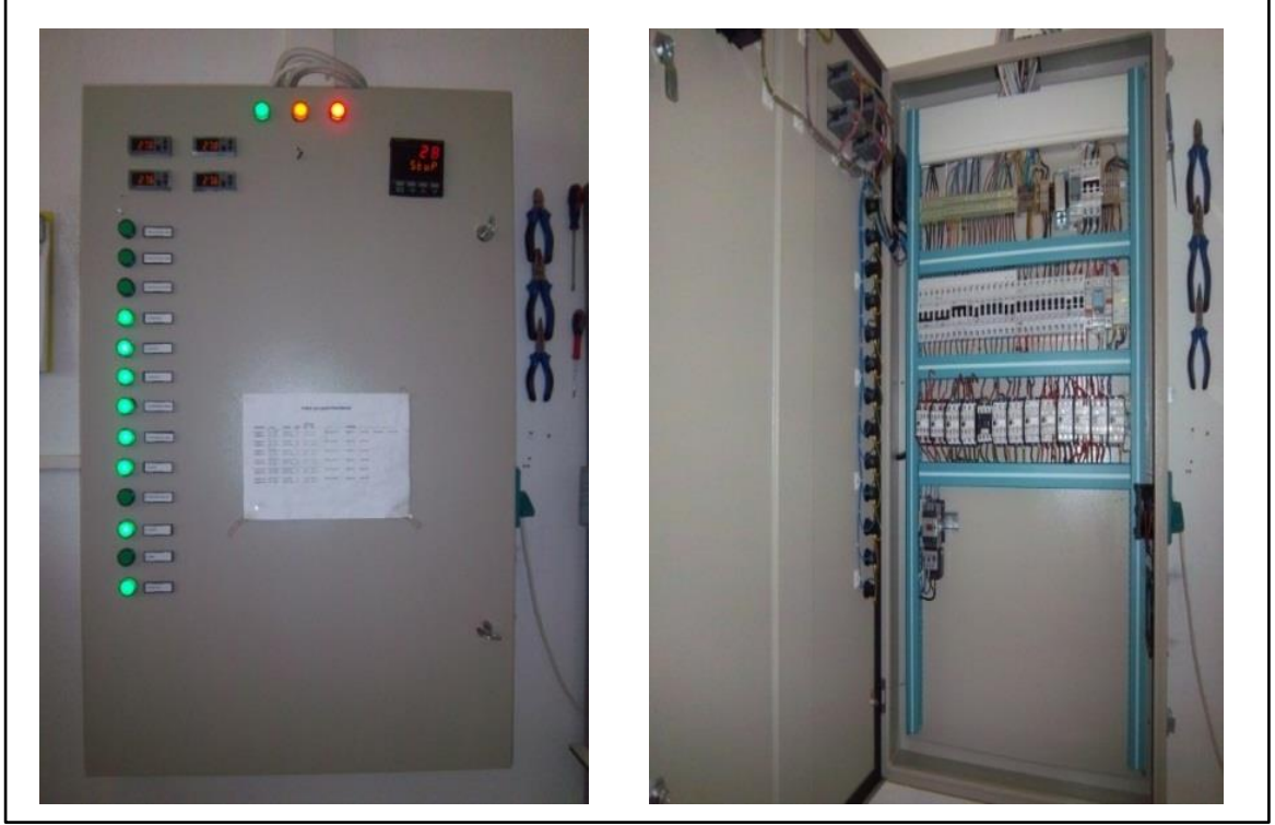
Şekil 3.2. İklim odası otomatik kontrol panosunun dıştan ve içten görünümü
