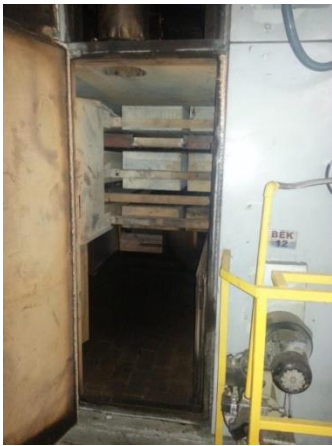
Şekil 5.6 Yünsa işletmesindeki katlı ramöz makinesinin iç kısmı
