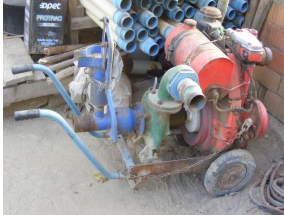
EK 18 Balaban köyü 18 no'lu pompaj tesisi
