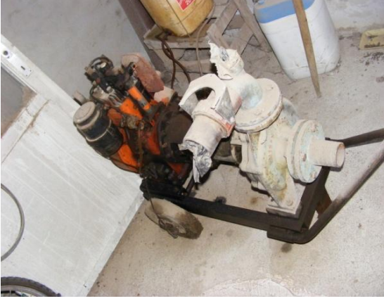
EK 21 Balaban köyü 21 no'lu pompaj tesisi
