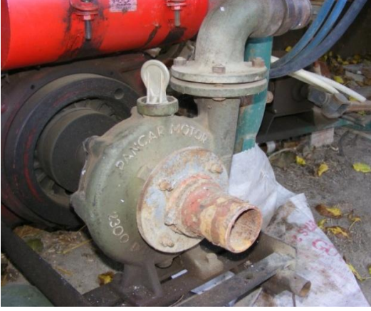
EK 28 Balaban köyü 29 no'lu pompaj tesisi
