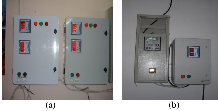
Şekil 3.11. Denemede kullanılan elektrik panosu ve sayacı, monofaze panolar (a), trifaze pano ve elektrik sayacı (b)
