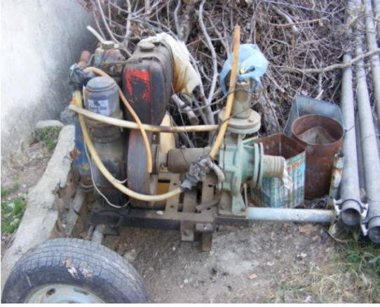
EK 20 Balaban köyü 20 no'lu pompaj tesisi
