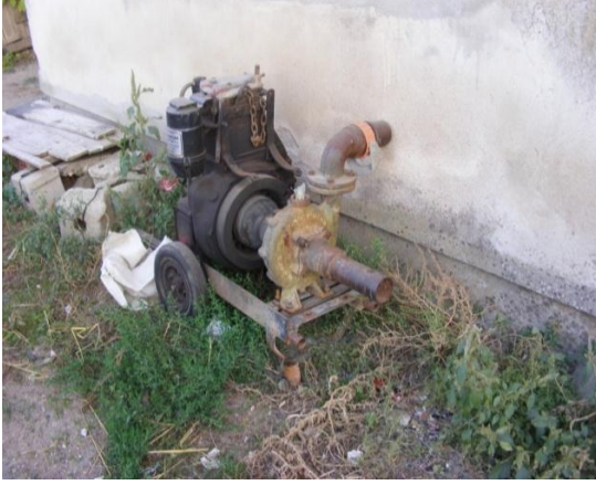
EK 19 Balaban köyü 19 no'lu pompaj tesisi
