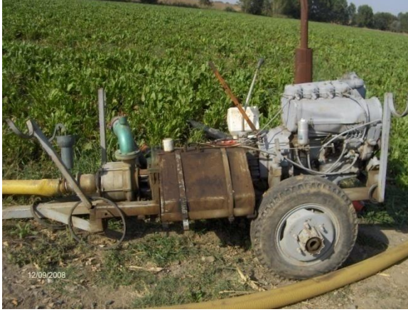
EK 16 Ortaca köyü 10 no'lu pompaj tesisi
