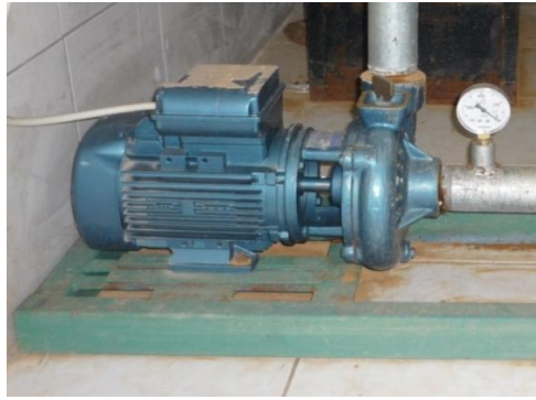
Şekil 3.3. Denemede kullanılan monoblok santrifüj pompa (dökme demir çarklı)
