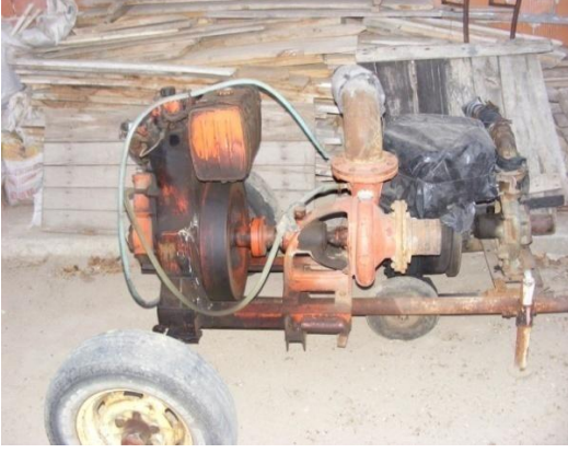
EK 32 Uzunköprü 33 no'lu pompaj tesisi
