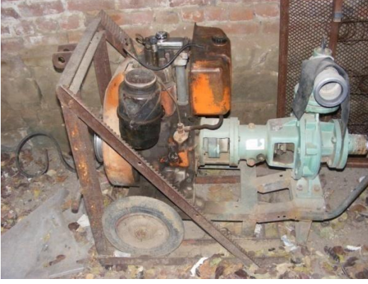
EK 30 Uzunköprü 31 no'lu pompaj tesisi
