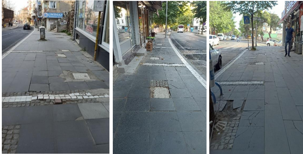
Şekil 4.20. Muratlı Caddesi yaya yürüyüş koridoru döşeme üzerinde oluşan çatlak ve kırıklar (Orijinal 2022)
