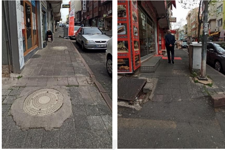
Şekil 4.33. Peştemalcı Caddesi yaya yürüyüş koridoru döşeme yüzeyi fiziksel durumu (Orijinal 2022)
