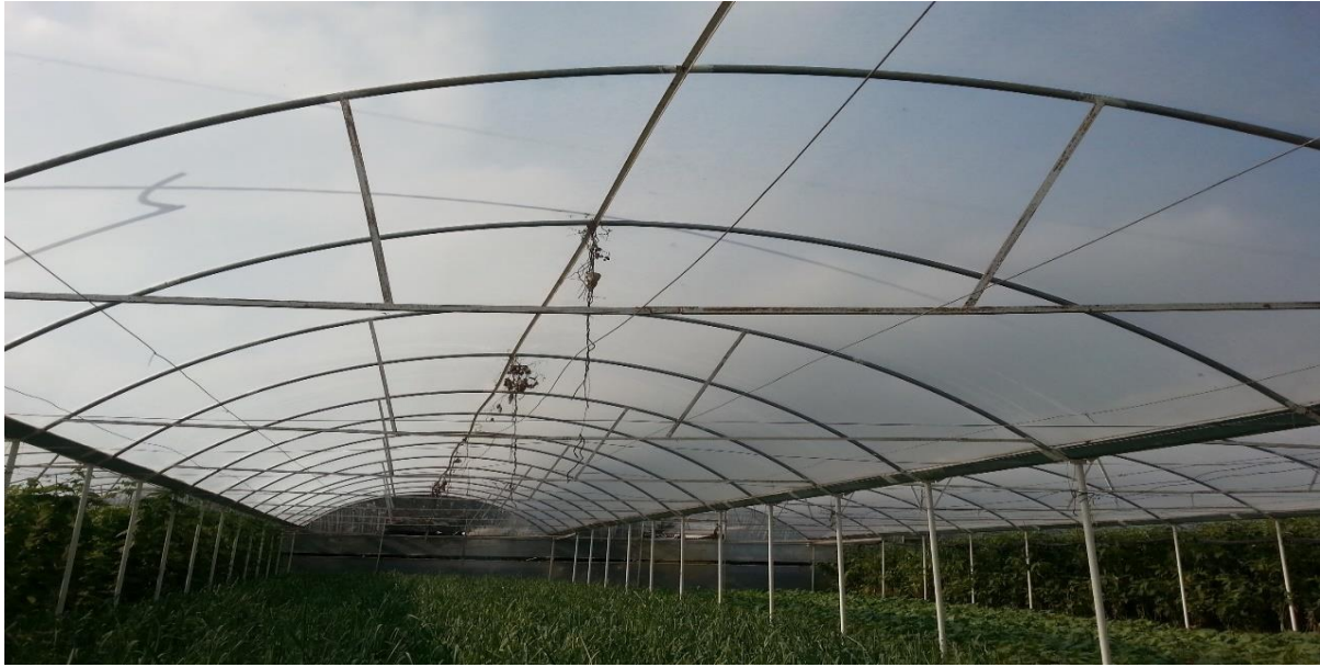
Şekil 4.6. Yay çatılı serada demir ve galvaniz malzemenin beraber kullanıldığı sera sistemi iç görünüşü (Sarıyer/ Gümüşdere,2015)
