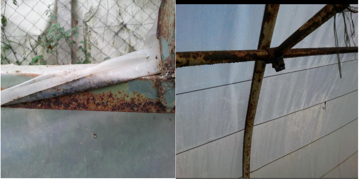
Şekil 4.13. Konstrüksiyonda oluşan korozyon (Pendik / Göçbeyli, 2016)
