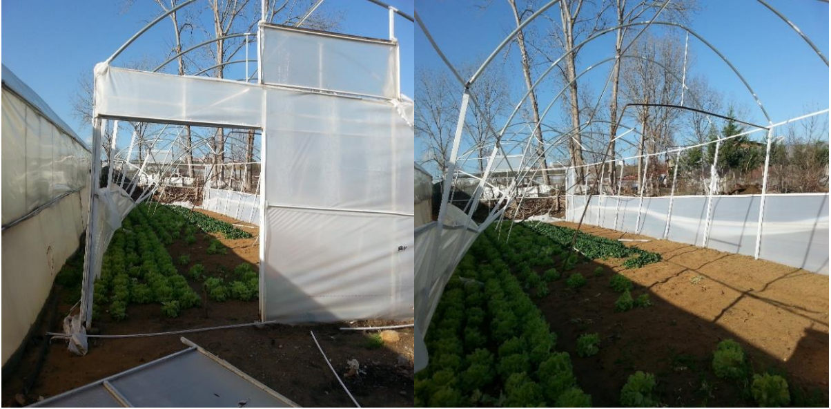
Şekil 4.21. Uygun olmayan malzeme ve yapım tekniğinin kullanılması sonucu yıkılan yay çatılı Sera (Sarıyer/Gümüşdere, 2015)
