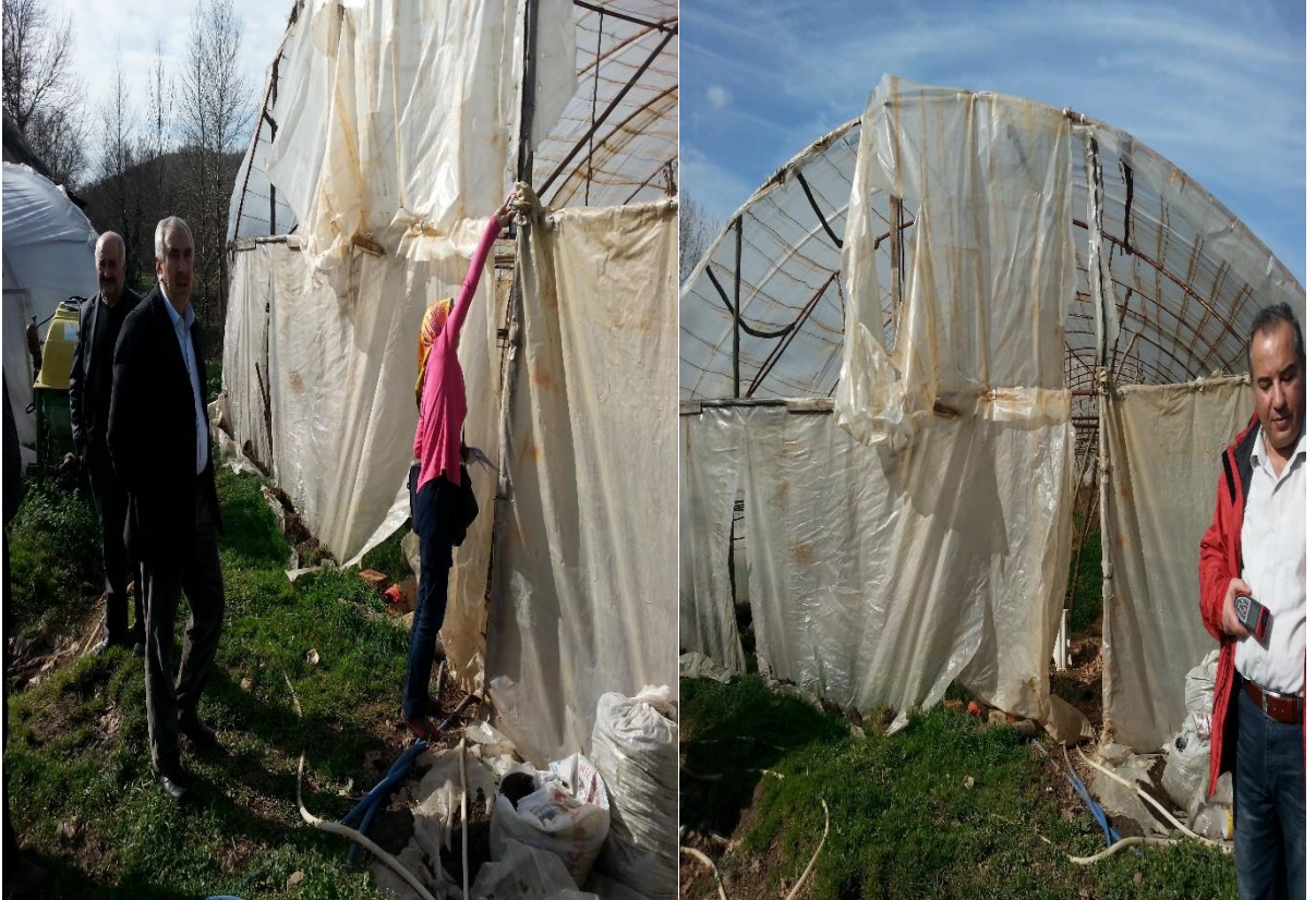
Şekil 4.43. Yüksek tünellerde oluşan deformasyon (Pendik /Göçbeyli, 2016)
