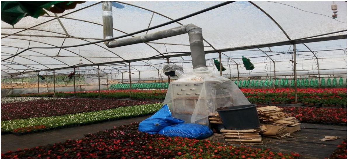
Şekil 4.40. Plastik örtülü serada sobalı üflemeli ısıtma sistemi (Sarıyer/Gümüşdere, 2015)
