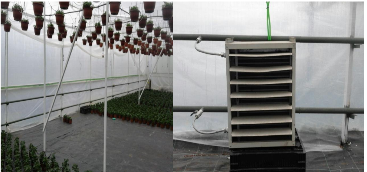
Şekil 4.38. Plastik örtülü serada kaloriferli ısıtma sistemi (Sarıyer/Gümüşdere, 2015)
