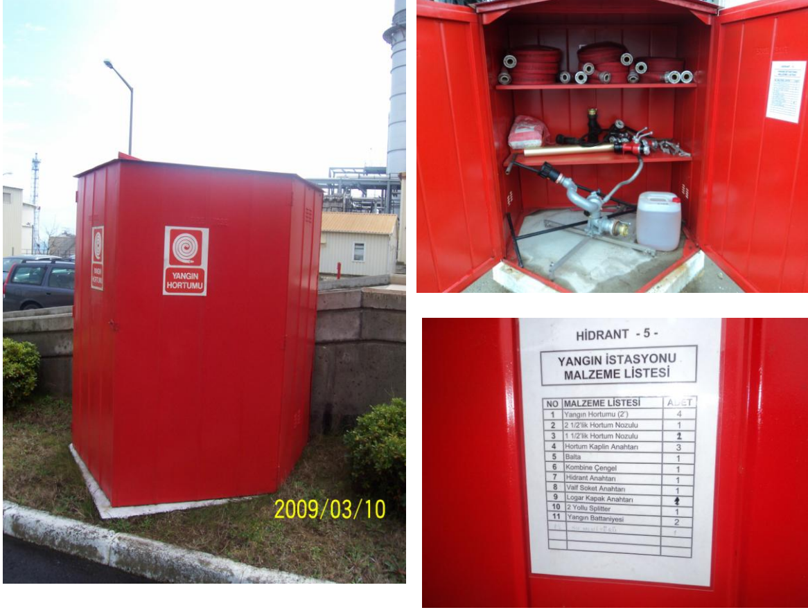
Fotoğraf 4.20: Santraldeki Yangın İstasyonu
