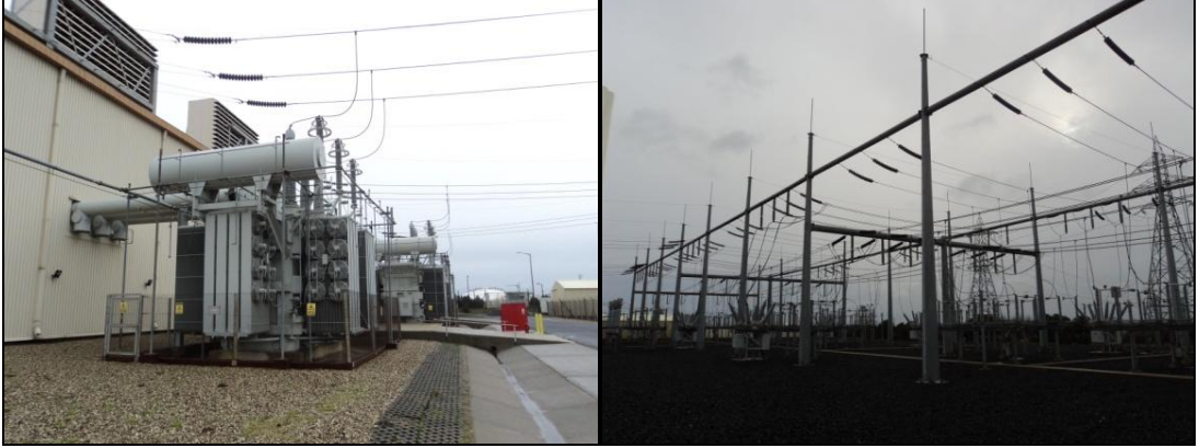
Fotoğraf 4.16: Trafo Bölgesi ve Şalt Sahası
