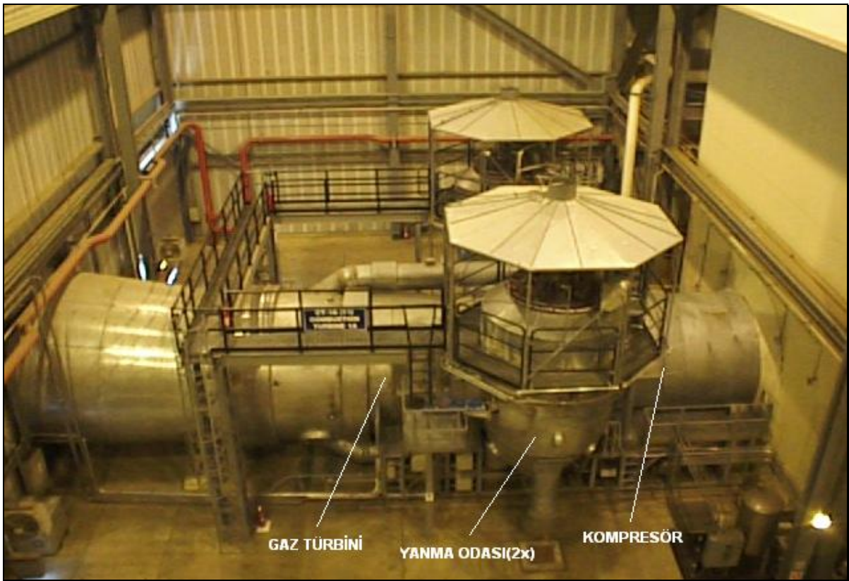
Fotoğraf 3.2: Marmara Güç Santralinde bulunan gaz türbini
