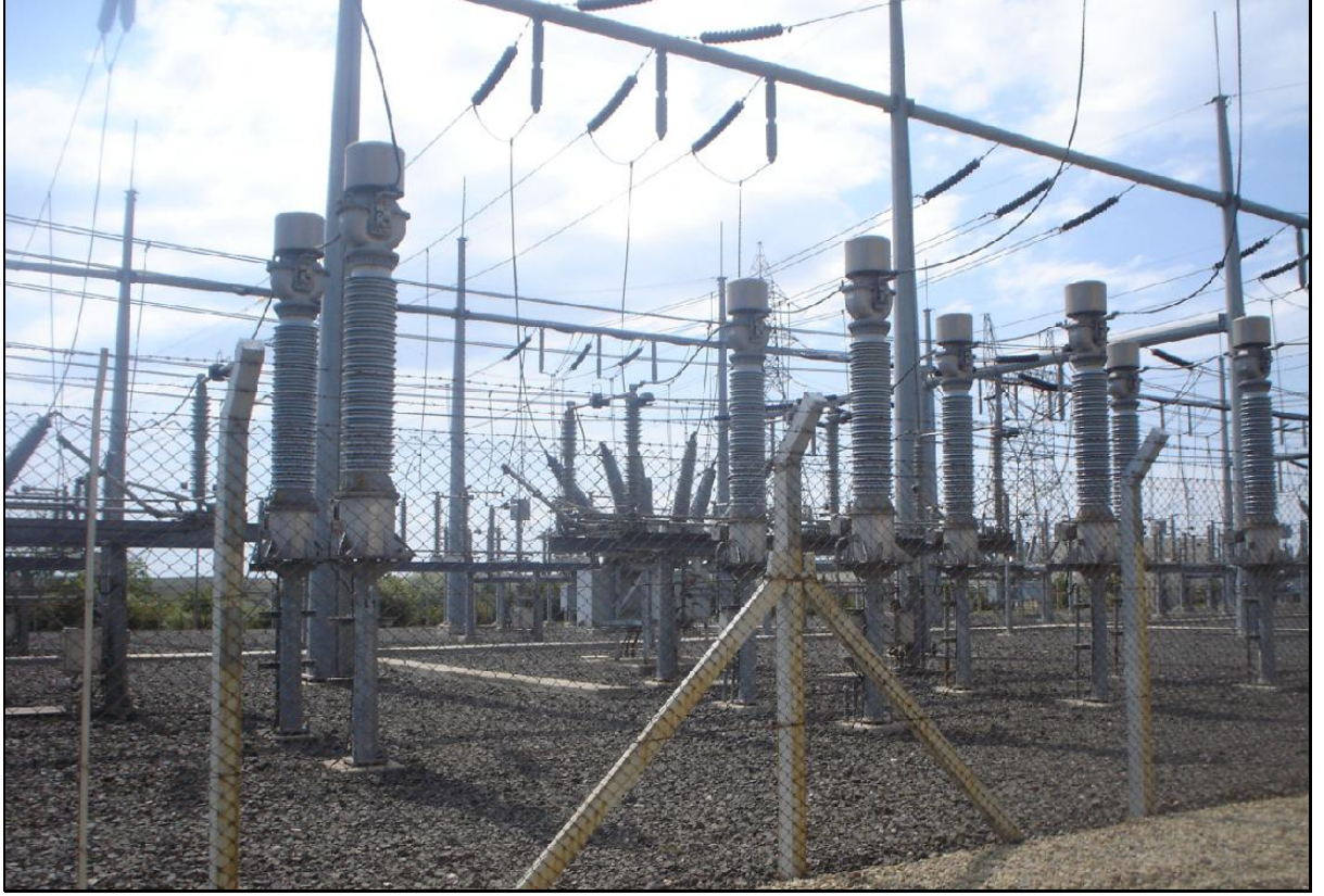
Fotoğraf 3.10: Marmara Güç Santrali Şalt Sahası
