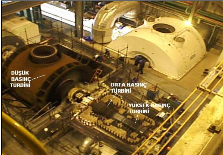
Fotoğraf 3.6. Buhar Türbini iç kısım: düşük basınç, orta basınç, yüksek basınç türbinleri
