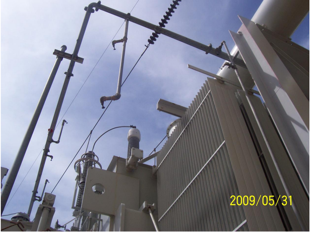
Fotoğraf 4.19 : Trafo Bölgesindeki Yağmurlama (Sprinkler) Sistemi
