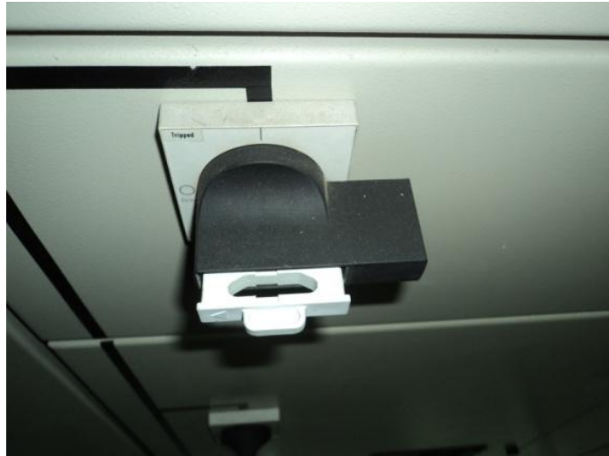
Fotoğraf 4.8: Elektrik Panosunda Kilitleme Sistemi
