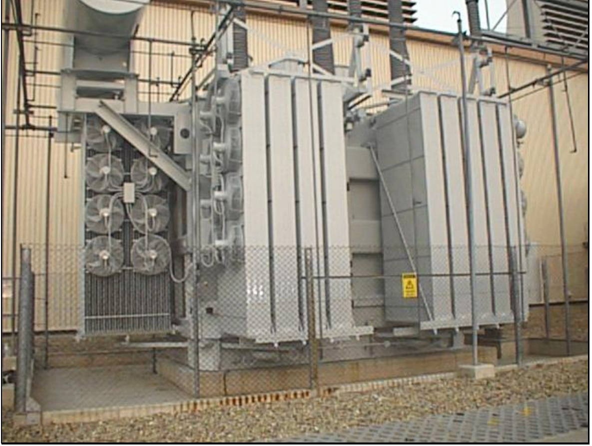
Fotoğraf 3.8: Marmara Güç Santralinde bulunan trafolar
