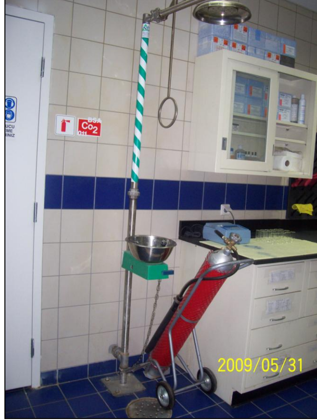
Fotoğraf 4.11: Laboratuarda bulunan göz duşu ve yangın söndürme tüpü
