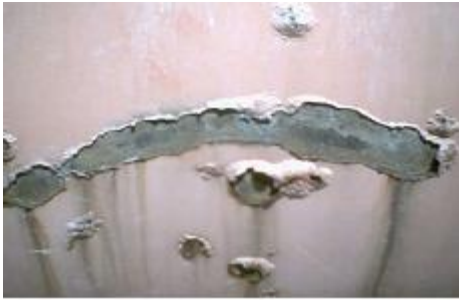
Şekil 2. 29. Boya altından yürüyen fili form korozyonunun görünümü ( Anonim 2000 )
