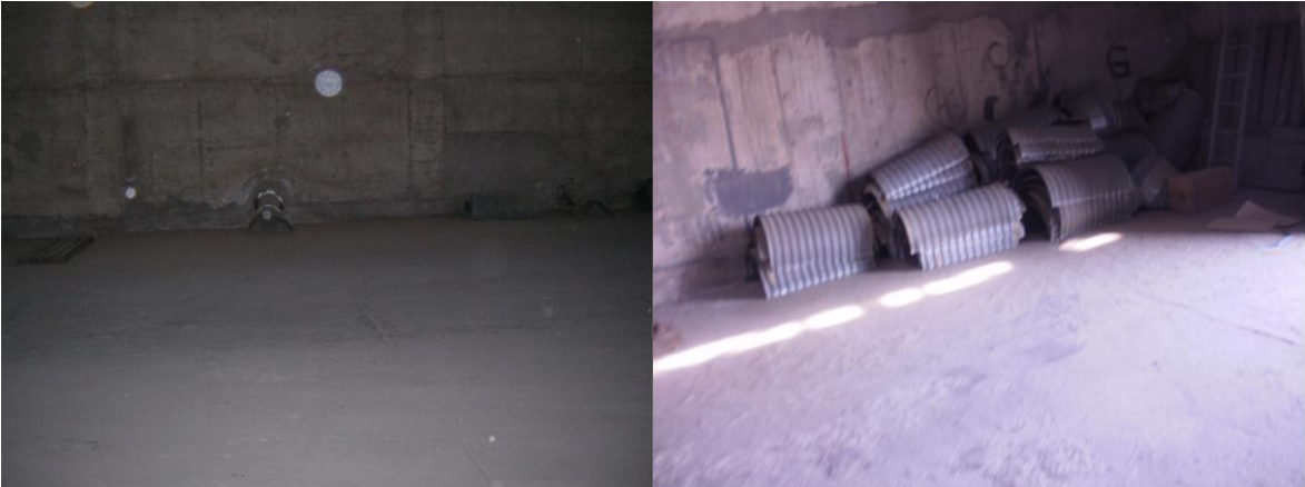
Şekil 6. MUD içerisindeki havalandırma kanalları
