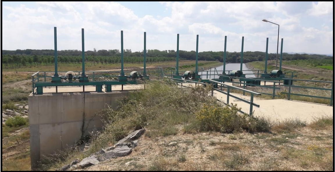
Şekil 3.12. Altinyazı Karasaz ve Sultanköy pompa istasyonu Meriç nehri su alımı
