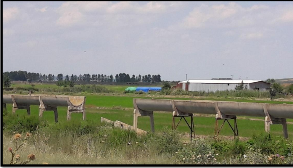
Şekil 4.36. Tefikiye köyünde atıl durumda olan kanaletlerden görünüm
