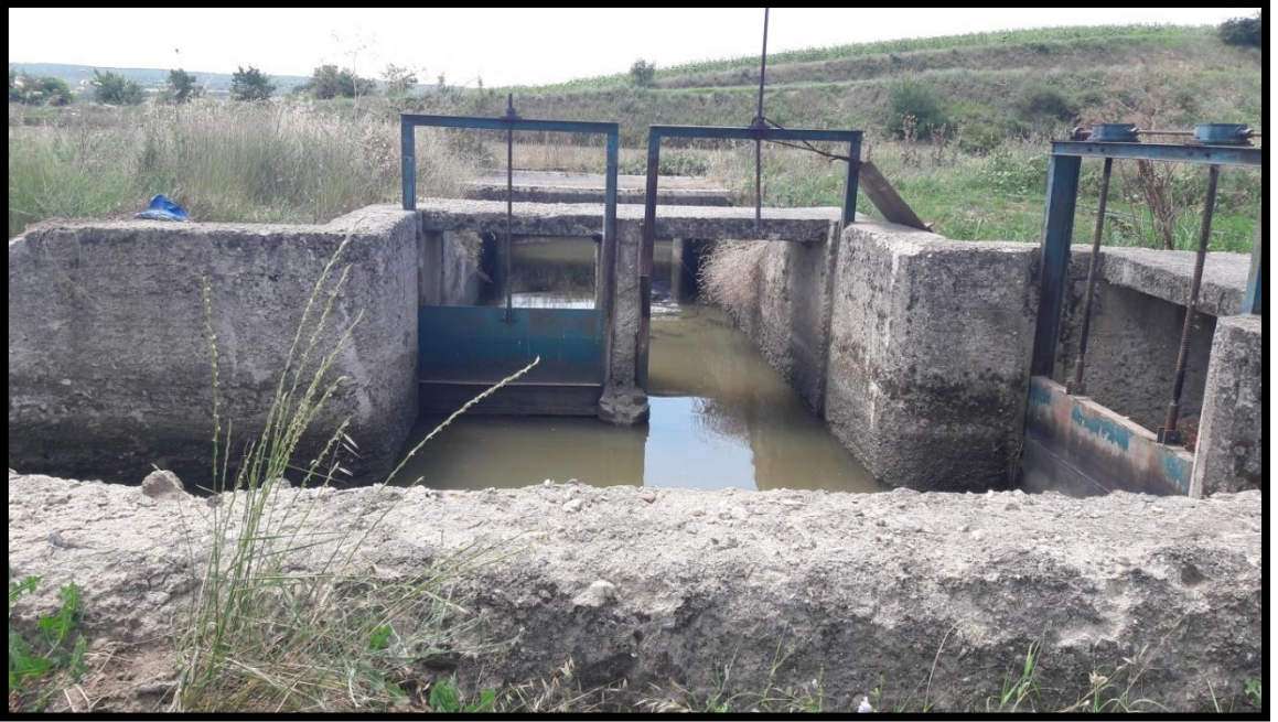
Şekil 4.22. Sarıcaali pompa istasyonundaki ana kanal çıkışı
