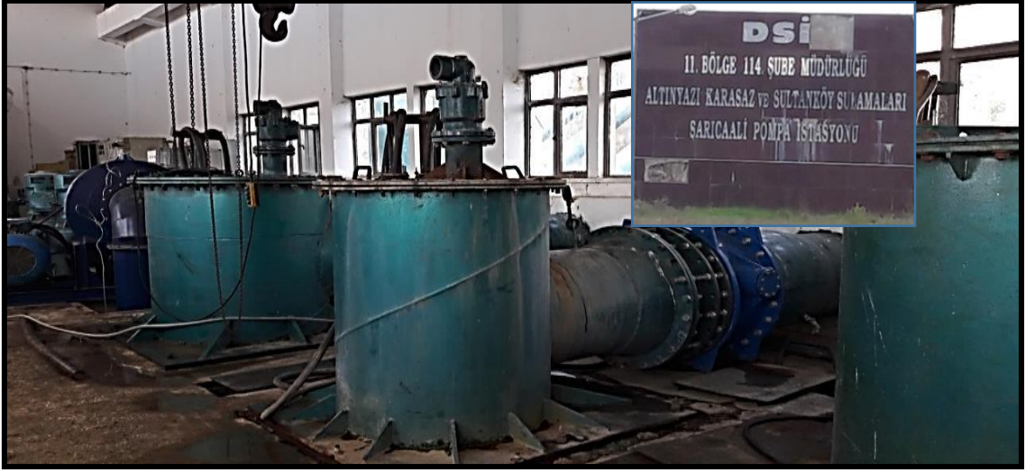
Şekil 3.11. Altinyazı Karasaz ve Sultanköy pompa istasyonu
