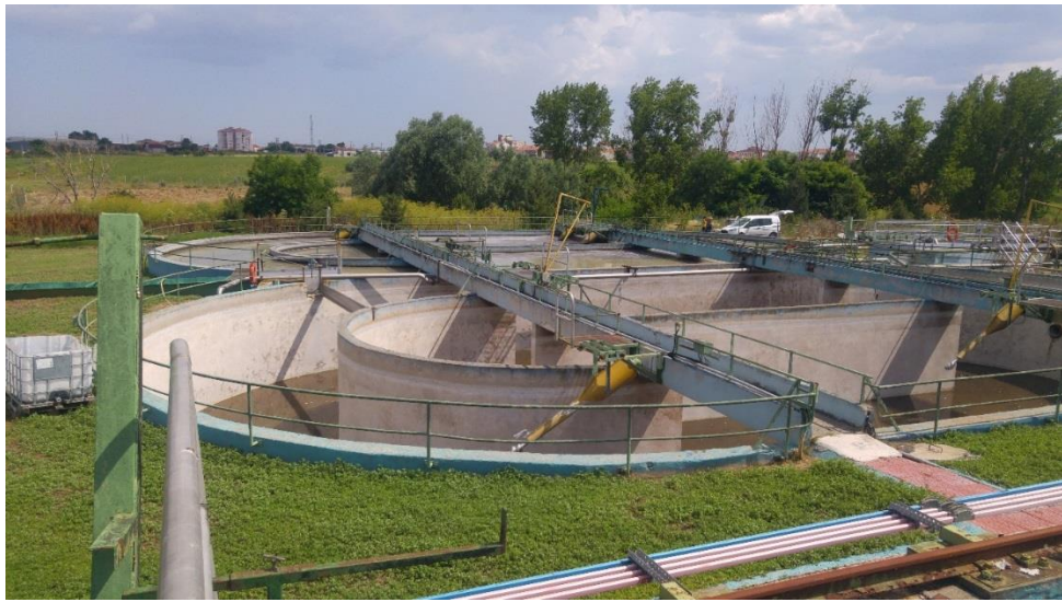
Şekil 3.7. Havalandırma tankları ve fuchs aeratörler
