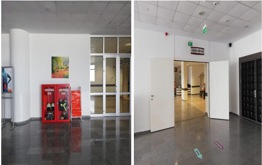
Şekil 6.8: Hastane Yangın Dolabı ve Bölüm Yangın Kapısı
