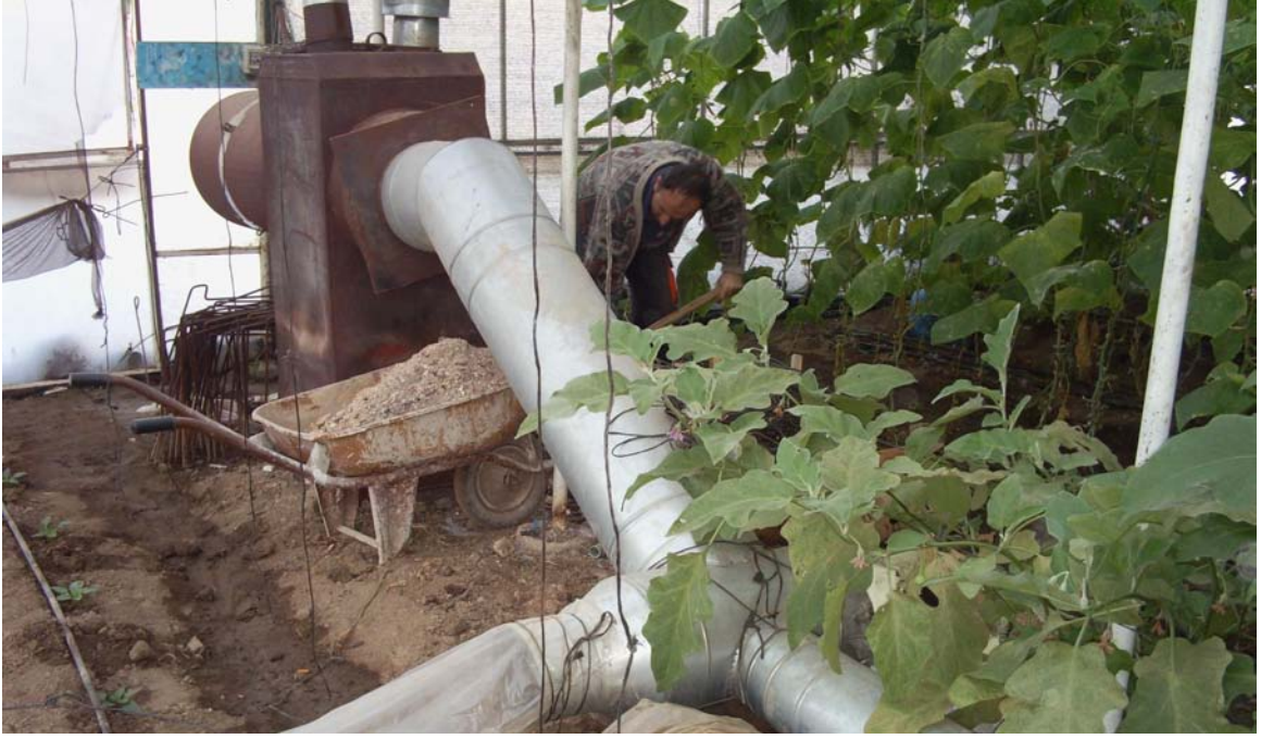
Şekil 4.5. Balıkesir araştırma yapılan seranın ısıtma sistemi (Ayşebacı köyü)
