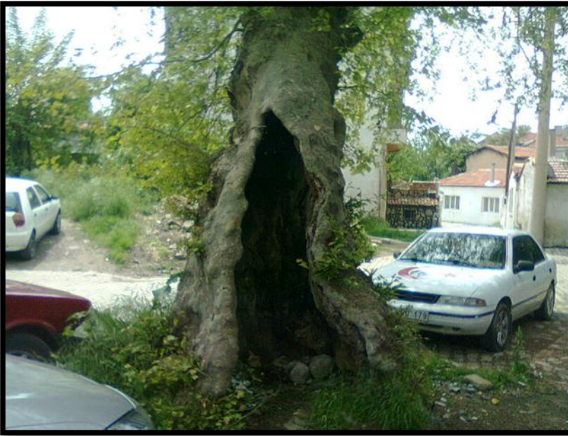
Şekil 5.6. Bakım ve onarımı yapılmamış ağaç örneklerinden birisi
