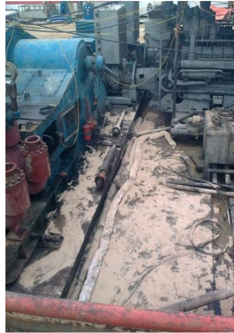
Şekil 4.36 Petrol/Doğalgaz sondaj çalışma alanında petrol/yağ döküntülerine karşı biyoremedasyon ürünü uygulaması
