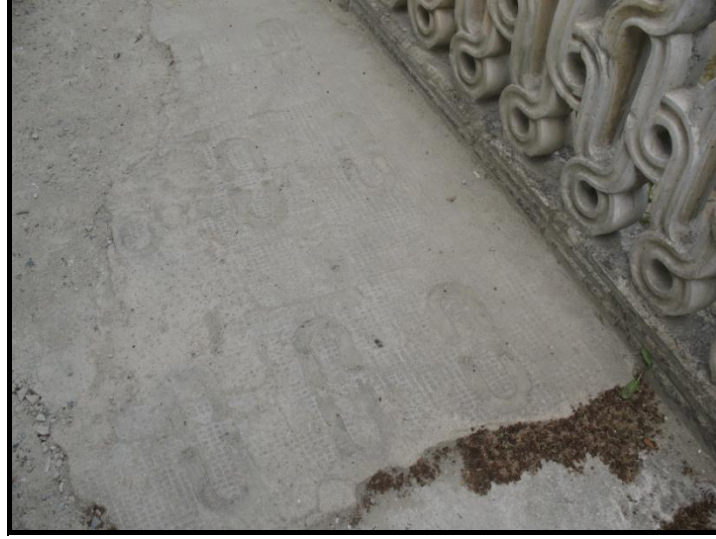
Şekil 4.71. Yolda meydana gelen hasarlar ve korkuluklar
