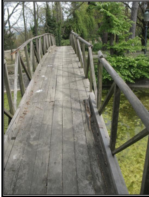
Şekil 4.104. Köprüde meydana gelmiş hasarlar
