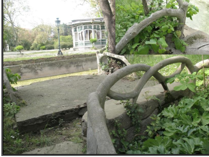
Şekil 4.34. Çardak yeri ve meydana gelmiş hasarlar
