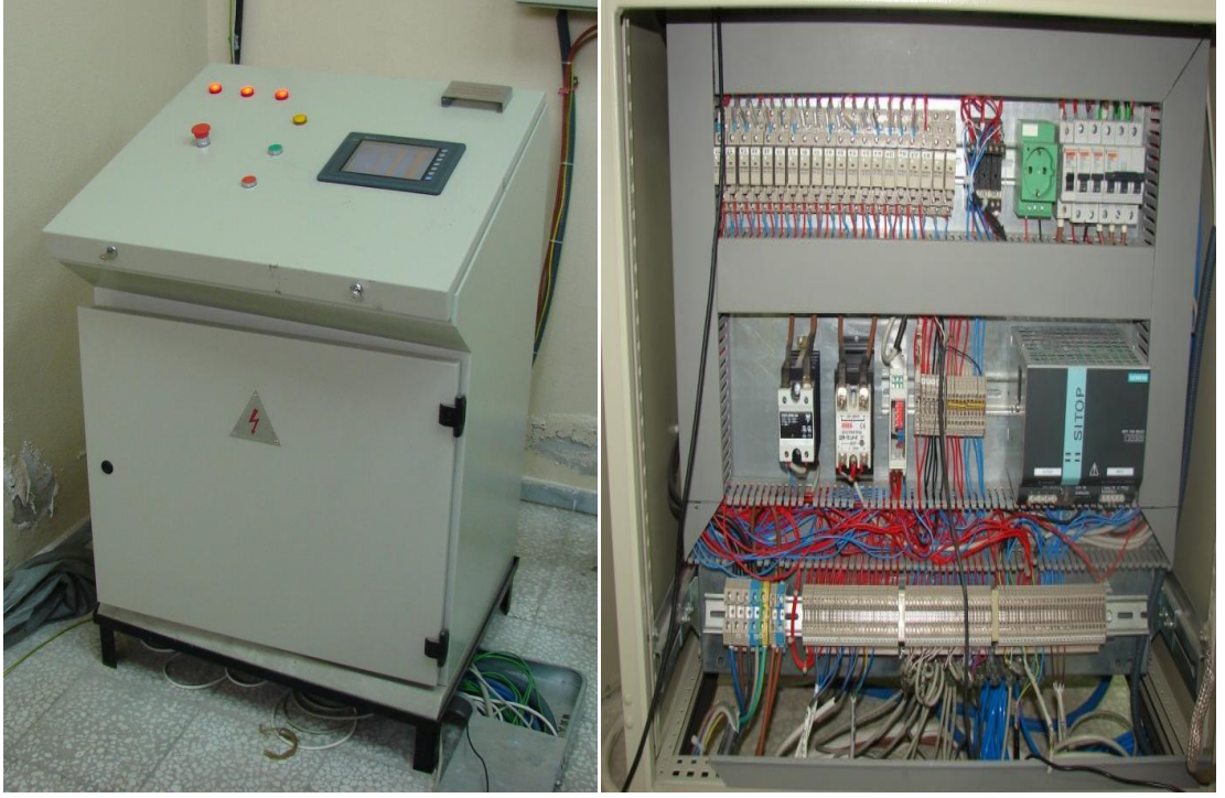
Şekil 5.11 PLC dış görünüm ve elektrik panosu (operatör kumanda paneli)
