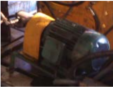
Şekil 3.8 Soğutucu fan hidrolik pompası
