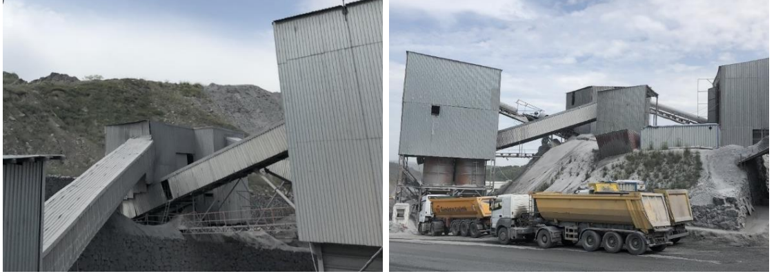
Şekil 3.12. Bant Konveyör, Eleme ve Silo Ünitelerinden Görüntüler
