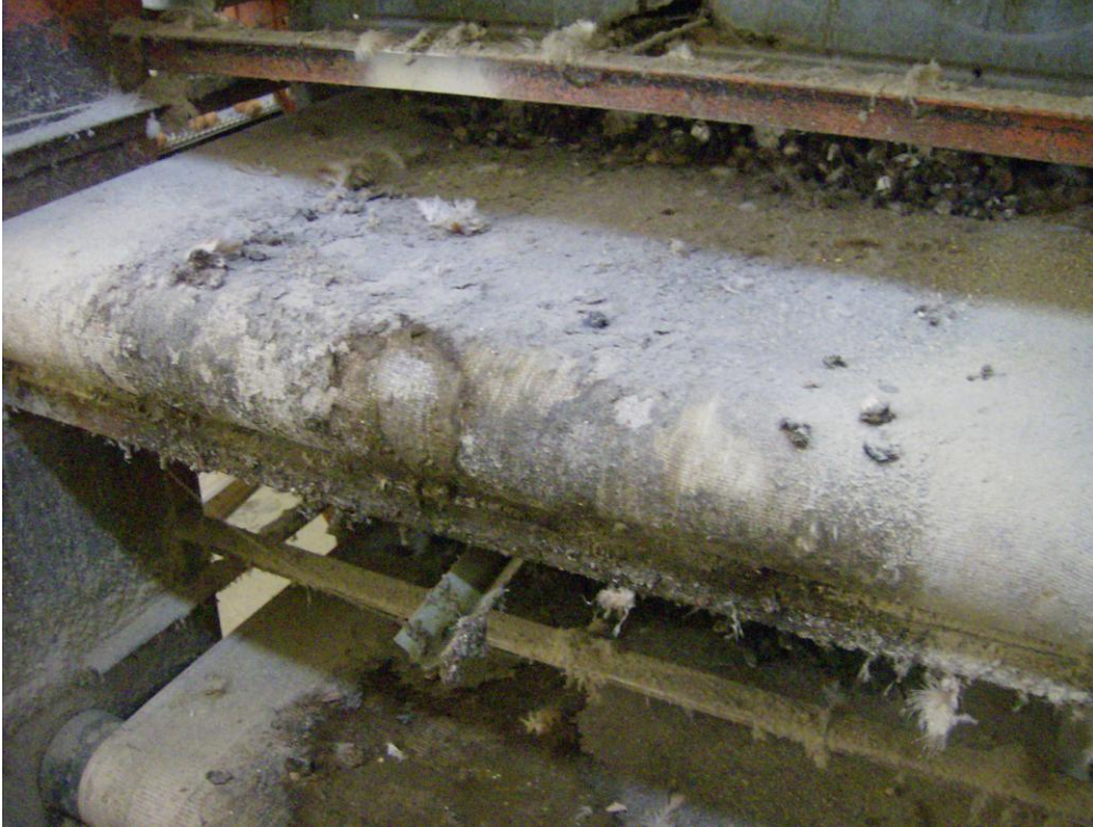
Şekil 4.13. Gübre toplama bandının 1 no'lu kümeden görünümü
