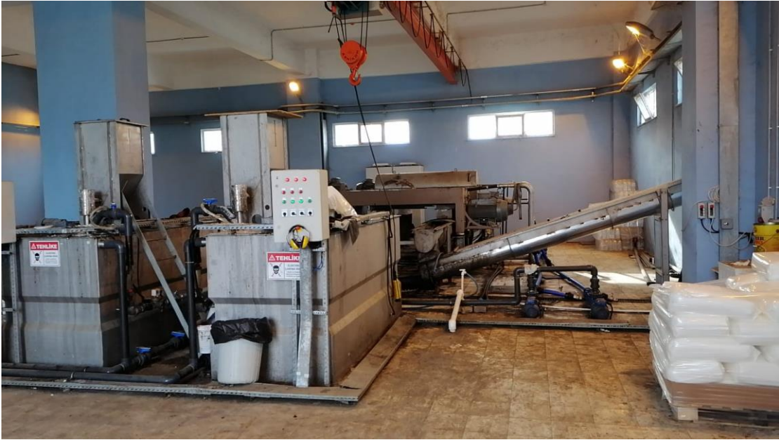
Şekil 3.3. Çamur susuzlaştırma ünitesi dekantör
