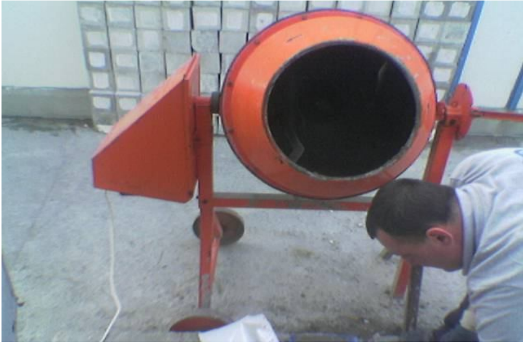
Şekil 3.10. Karışım Oranlarına Göre Hazırlanan Beton Karışımlarının Taze Beton Hazırlanması İçin Mikserde Karıştırılması
