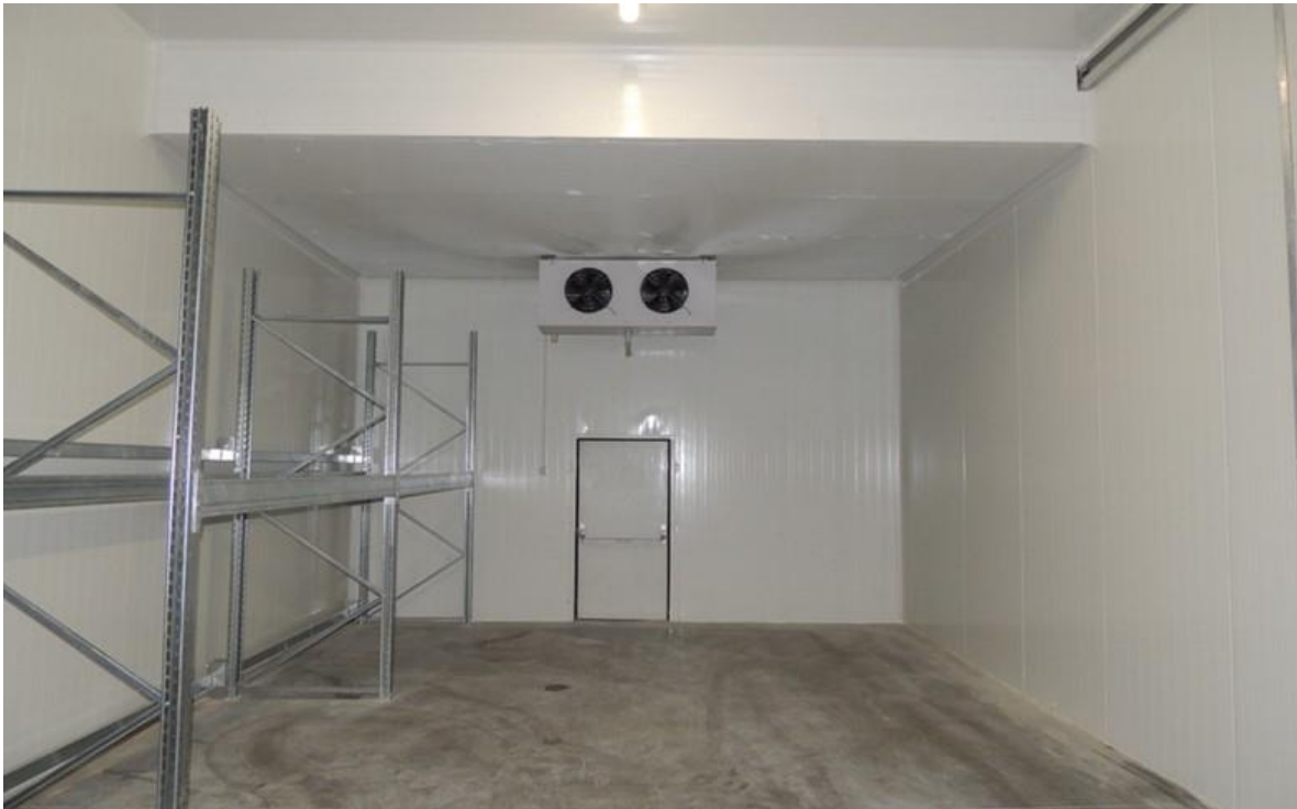
Şekil 4.14. Tuzla ilçesindeki ön soğutma odası bulunan işletmelerden biri
