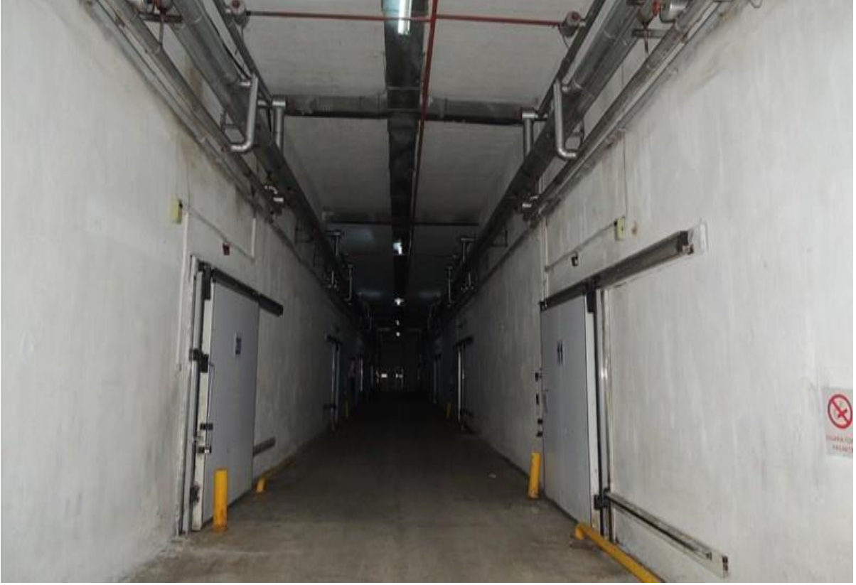
Şekil 4.17. Tuzla ilçesinde bir işletmenin soğuk odalarında kullanılan izometrik sürme kapı
