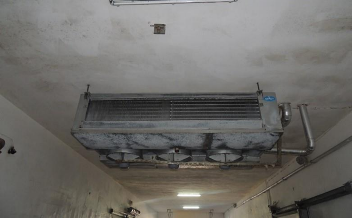
Şekil 4.28. Mekanik havalandırmanın olduğu bir işletme (Tuzla)
