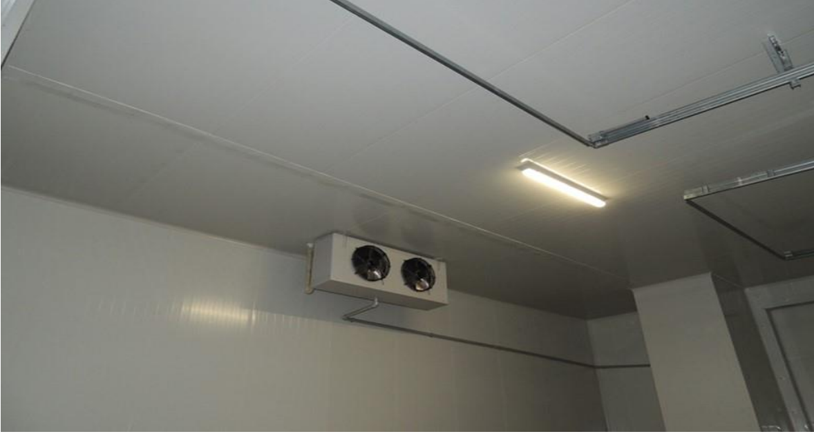
Şekil 4.34. Pendik ilçesindeki bir işletmenin asma tavan sistemi
