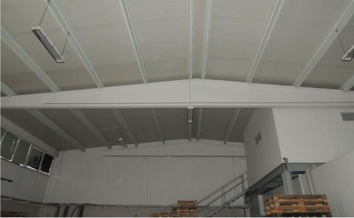
Şekil 4.36. Çatı örtü malzemesi EPS ve PU panel olan Sancaktepe ilçesindeki başka bir işletme
