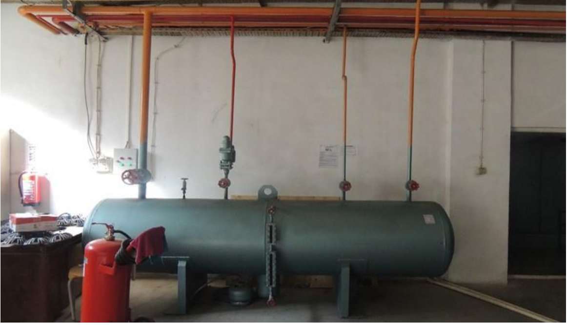
Şekil 4.10. Soğutucu maddesi amonyak olan bir işletmenin gaz tankı (Tuzla)
