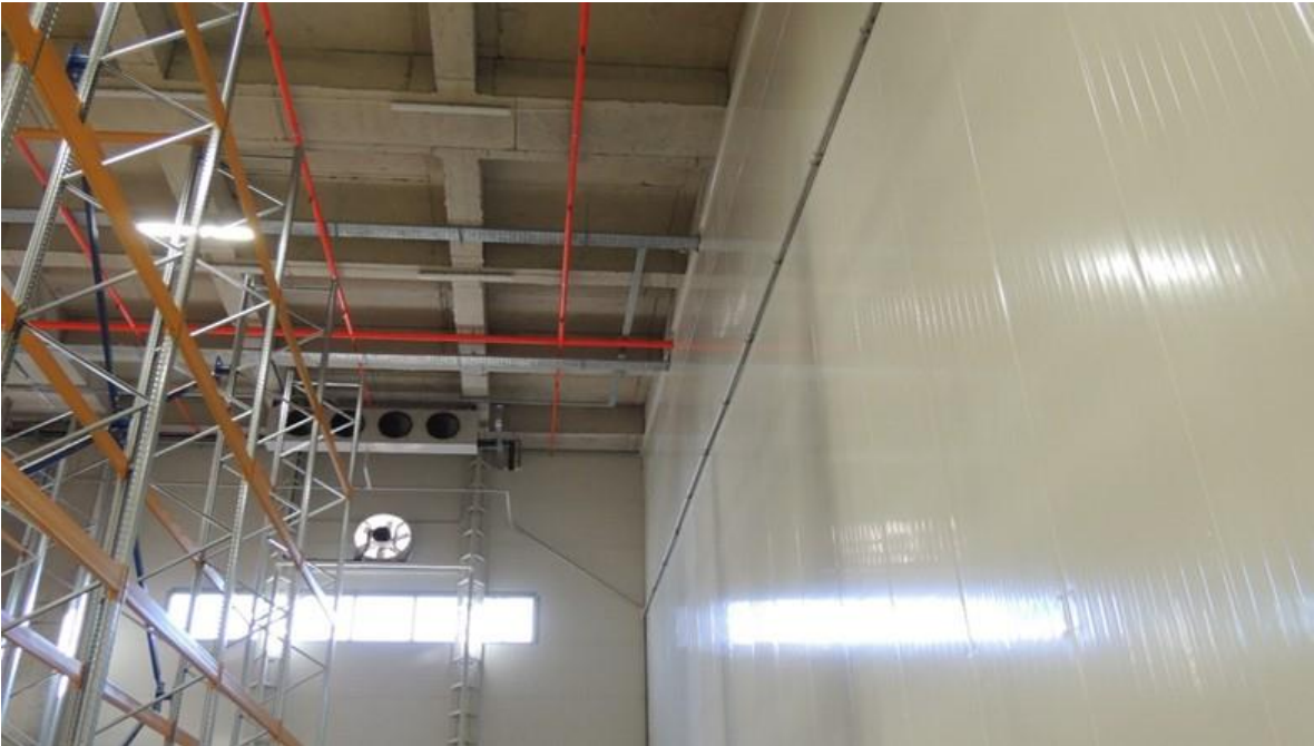
Şekil 4.29. Mekanik havalandırmanın olduğu başka bir işletme (Ataşehir)
