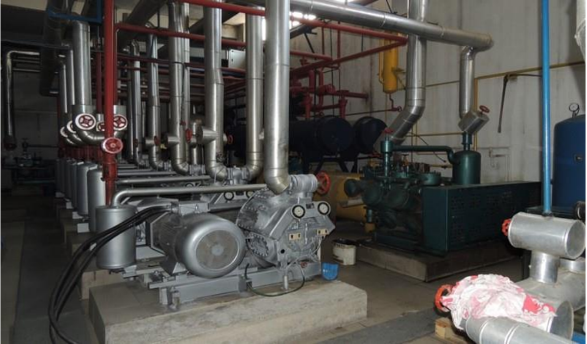
Şekil 4.16. Pendik ilçesindeki işletmenin soğutma sisteminden genel görünüm
