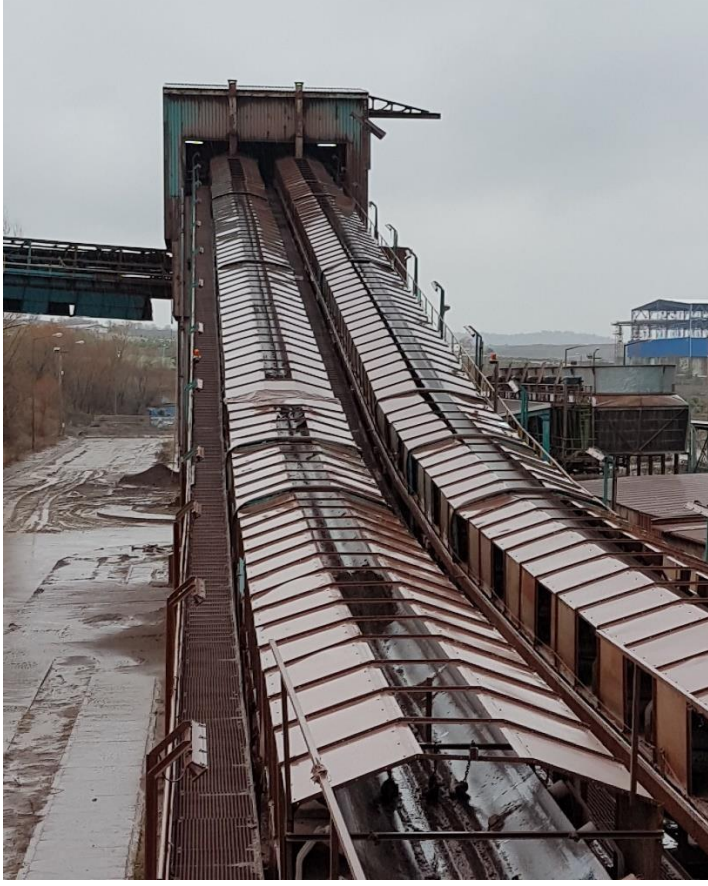
Şekil 4.3. Kömür konveyör bantları (Anonim 2015).
