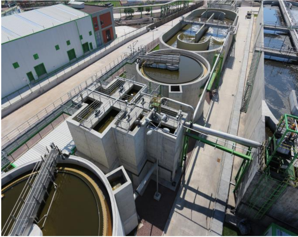
Şekil 4.3 Örnek OSB Atıksu Arıtma Tesisi Kimyasal Arıtma Ünitesi
