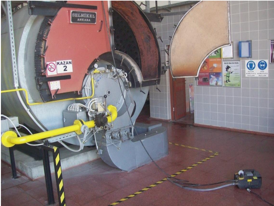
Şekil 4.1. Test pompasının bağlanmış hali
