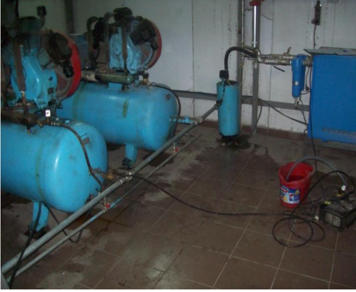
Şekil 4.18. Test pompasının hava tankına bağlanması
