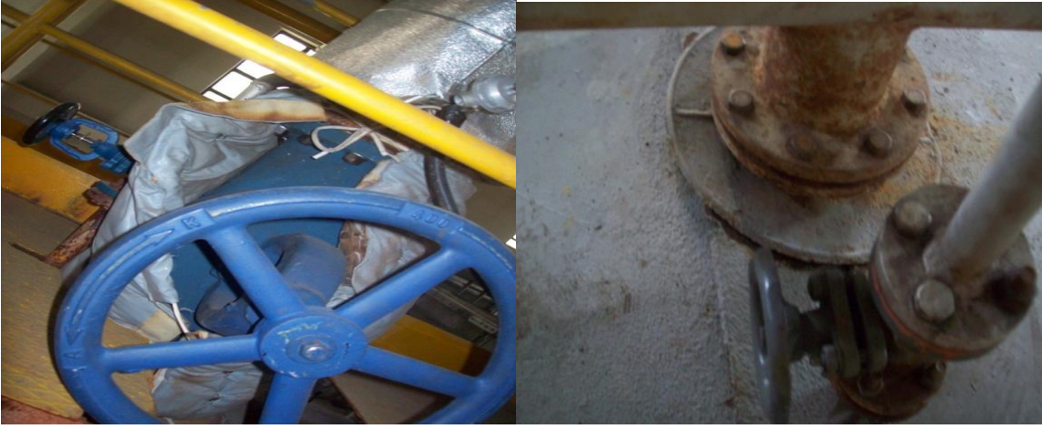
Şekil 4.16. Flanş bağlantısı (Gidiş – Dönüş vanası)
