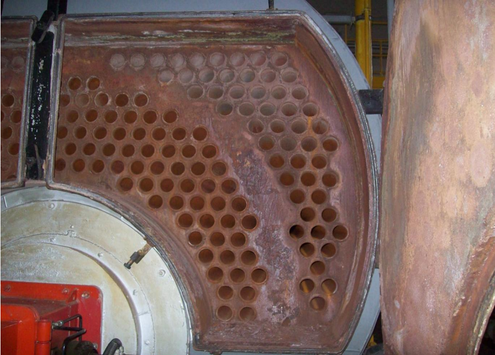
Şekil 3.8. Buhar kazanı aynası
