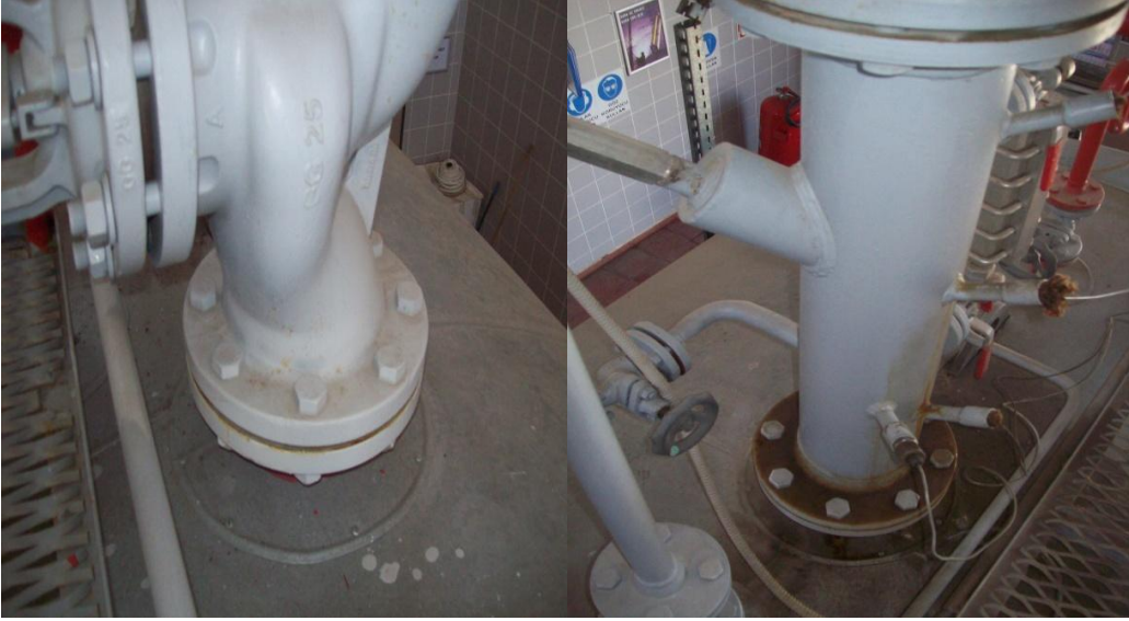
Şekil 4.8. Flanş bağlantısı (Gidiş – Dönüş vanası)
