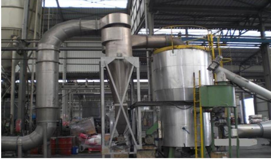
Şekil 3.2. Gazifikasyon verimliliği ile ilgili deneysel çalışmaların yürütüldüğü tesise ait çamur kurutma ünitesi
