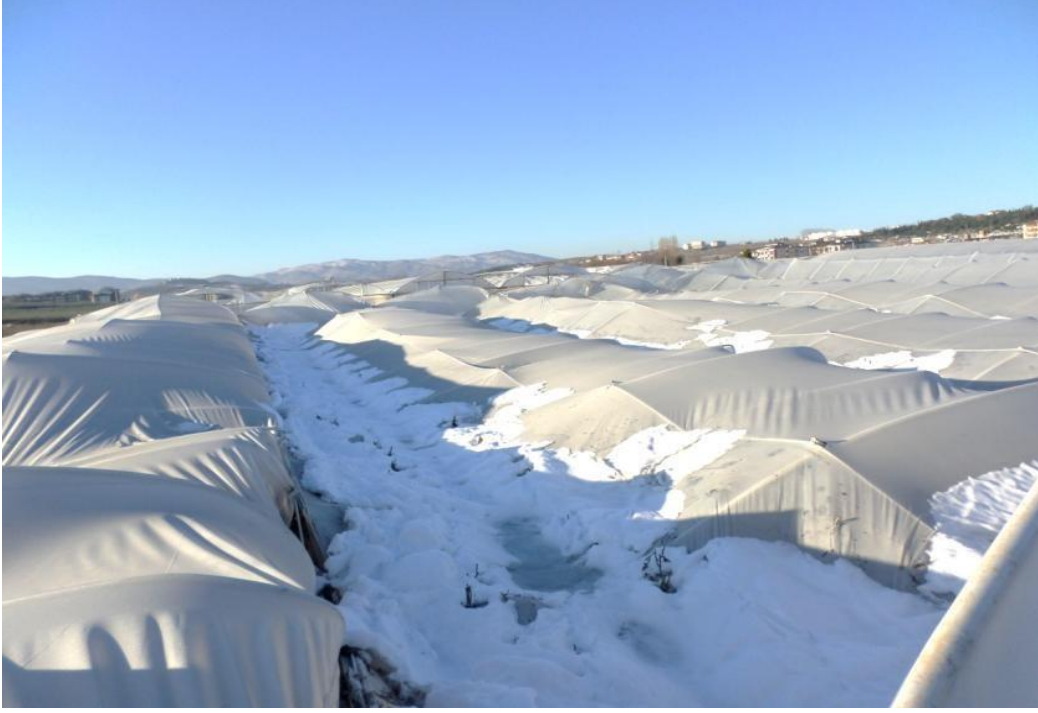
Şekil 4.26. Kar yükü sonucu konstrüksiyonda oluşan zarar (Yalova-İşletme no:9)
