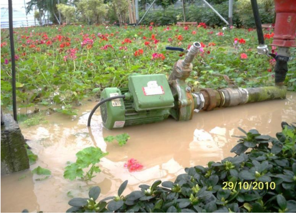
Şekil 4.9. Drenajı iyi olmayan serada su baskını zararı (Kocaeli-İşletme no:8)
