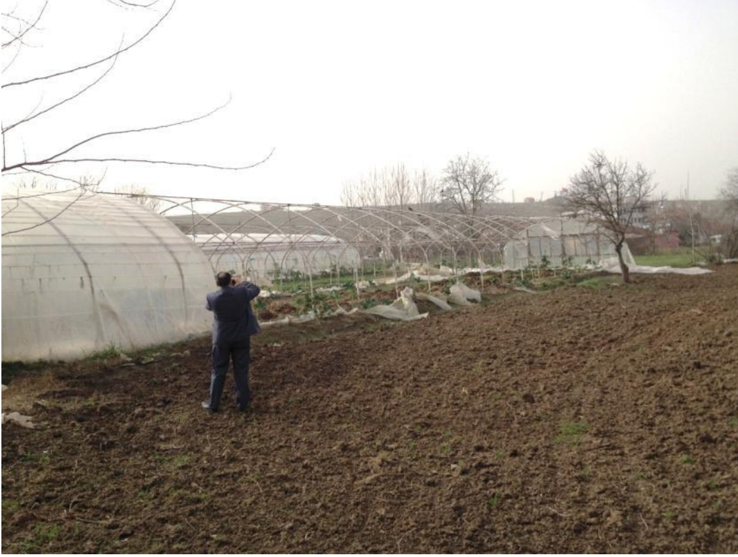
Şekil 4.14. Rüzgar yükü sonucu örtü malzemesinde oluşan zarar (Yalova-İşletme no:1)
