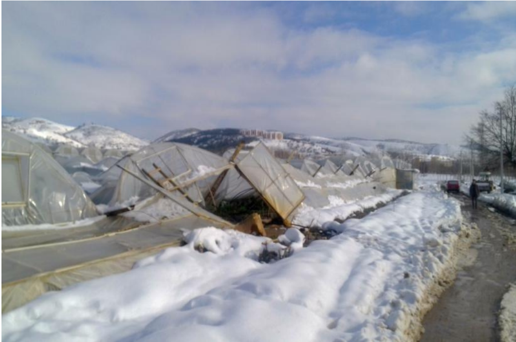
Şekil 4.22. Kar yükü sonucu konstrüksiyonda oluşan zarar (Yalova-İşletme no:7)
