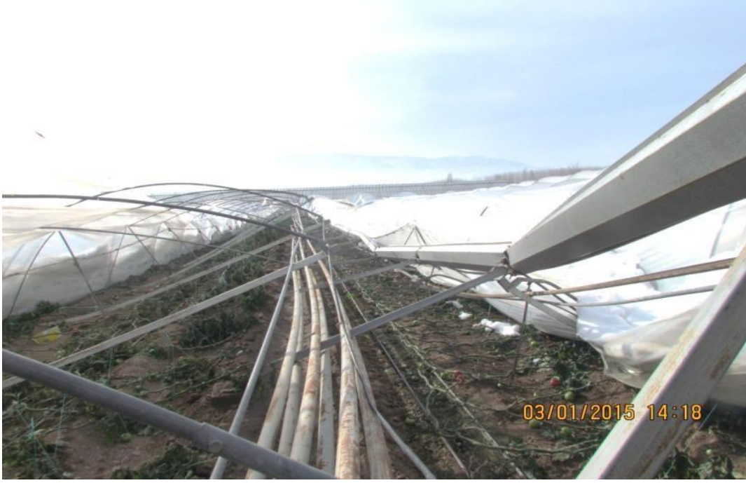
Şekil 4.23. Kar yükü sonucu metal konstrüksiyonda oluşan zarar (Yalova-İşletme no:7)
