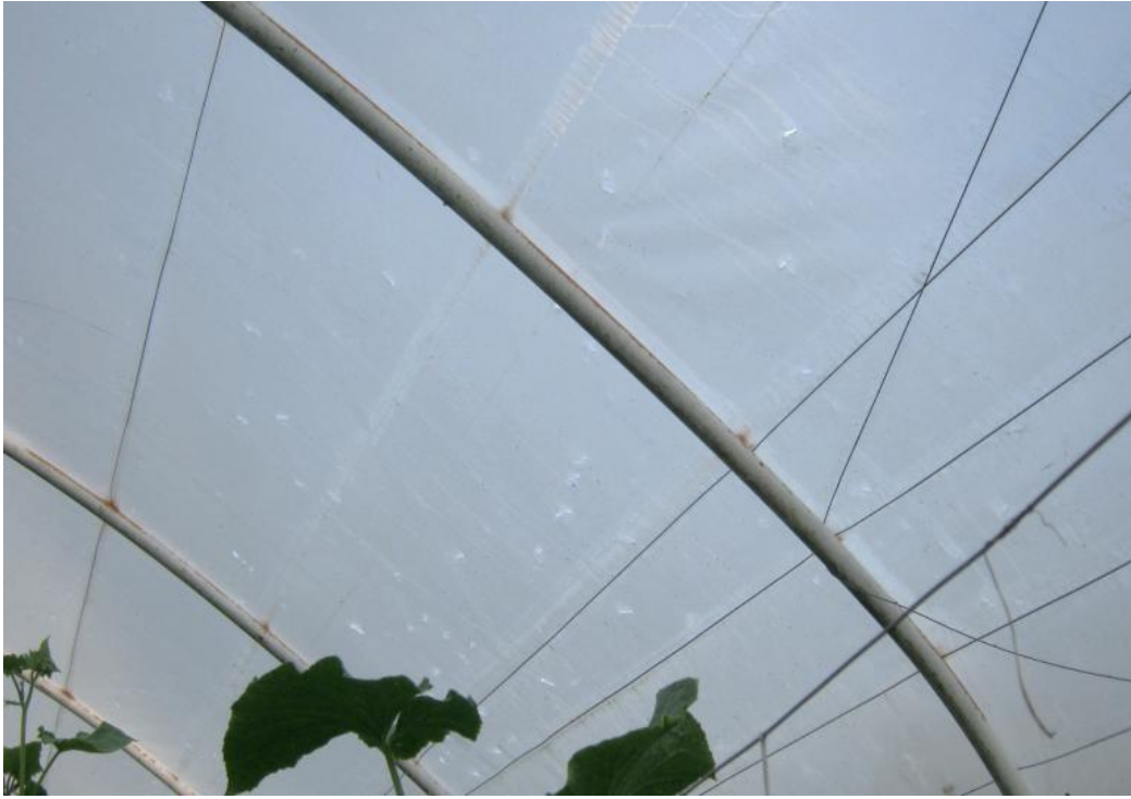
Şekil 4.35. Dolu yağışının pvc örtüde oluşturduğu zarar (Kocaeli-İşletme no:10)
