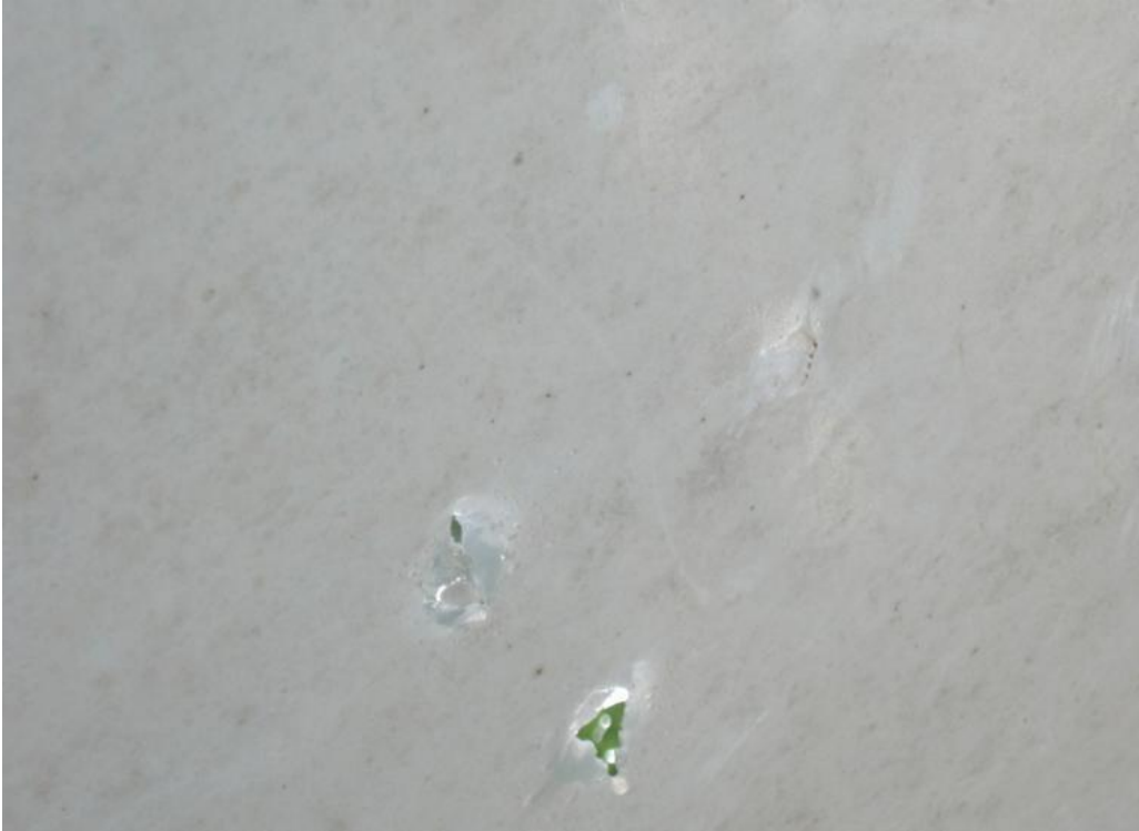
Şekil 4.37. Dolu yağışının pvc örtüde oluşturduğu zarar (Kocaeli-İşletme no:10)
