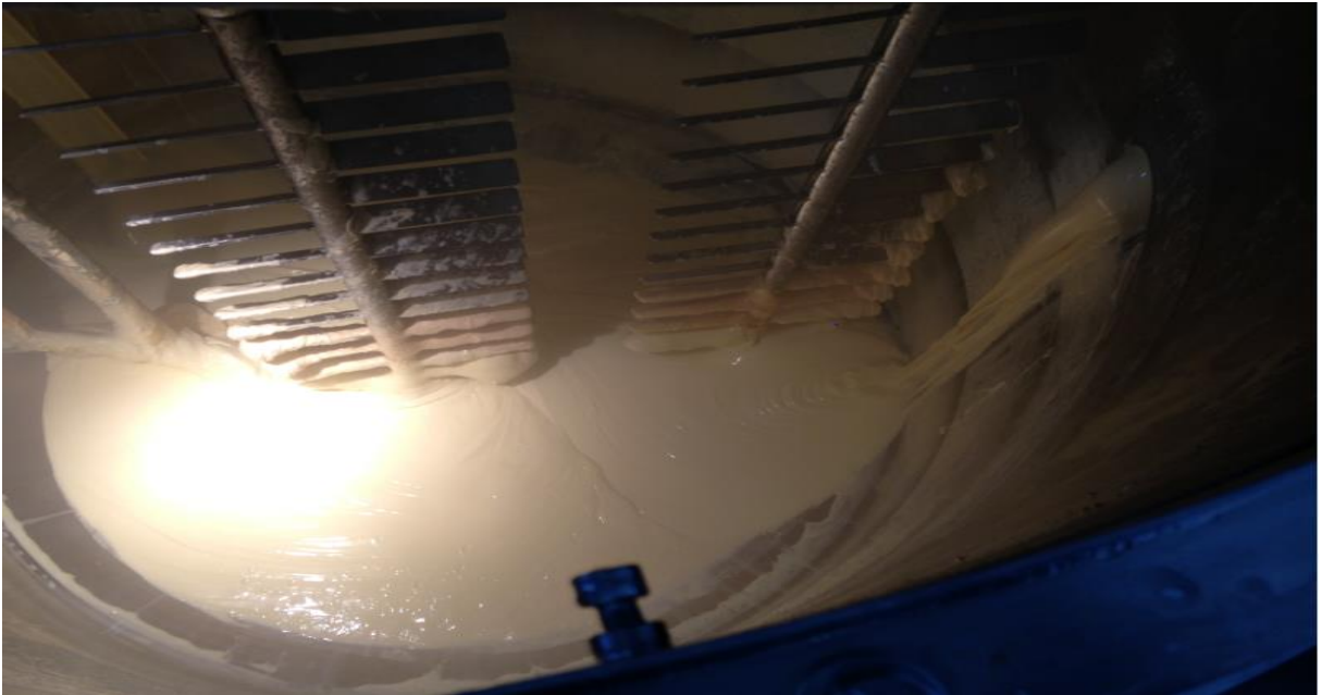
Şekil 3.8. UHT sonrası buffer tank görünümü
