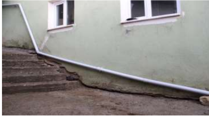
Şekil 3.8. Zemin oturmasına bağlı yapıda oluşan çatlaklar (Anonim, 2019).
