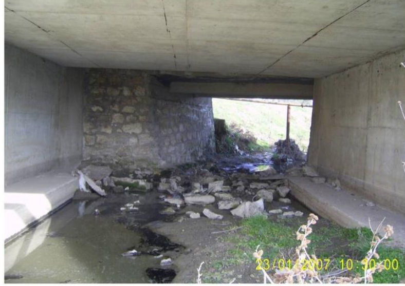
Şekil 3.9. Dere akış kesitini daraltan yapı
