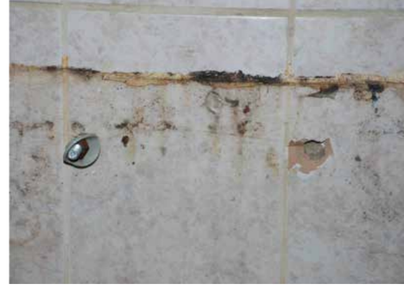
Resim 2: Lavabonun duvardaki monte yeri
