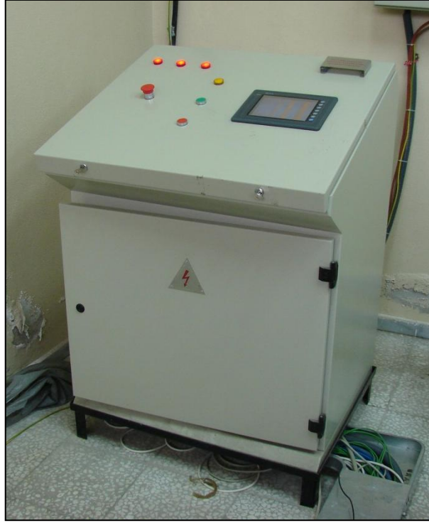
Şekil 3.13 PLC dış görünüm - Elektrik panosu (operatör kumanda paneli)
