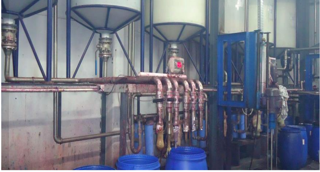
Şekil 4.11. Boya Mutfağı Fotoğrafi
