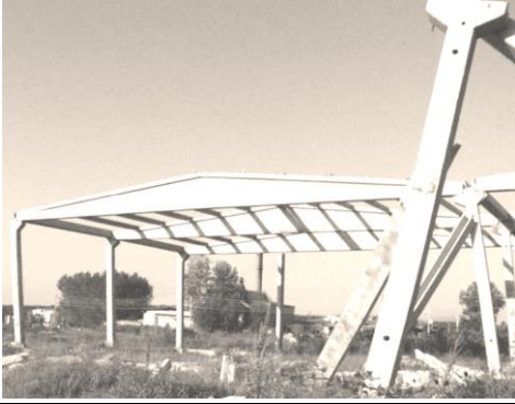
a) Taşıyıcı sistemin genel hasarı
