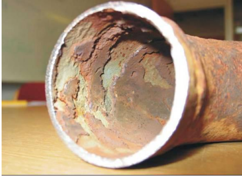
Şekil 5.7. Karbonik asidin neden olduğu korozyon (Danfoss 2005)
