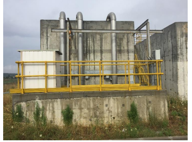
Şekil 3.11. Dengeleme Terfi Pompa İstasyonu
