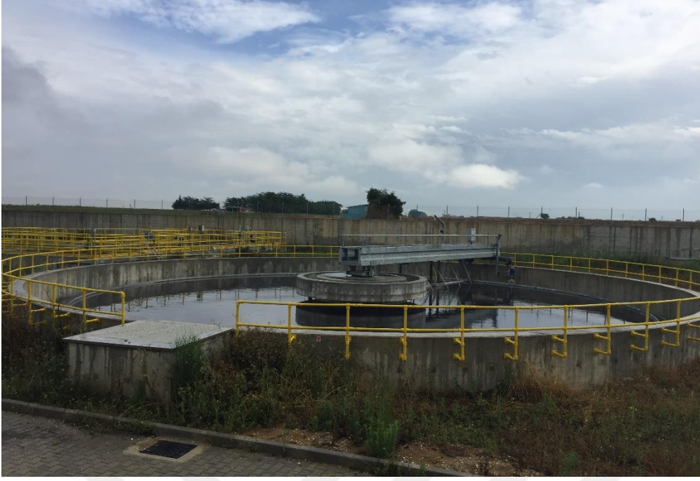
Şekil 3.19. Kimyasal Çöktürme Havuzu
