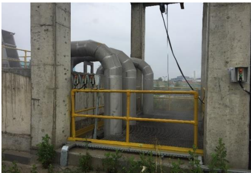
Şekil 3.7. Giriş Terfi Pompa İstasyonu
