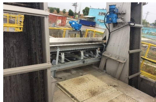
Şekil 3.8. İnce Izgara Ünitesi
