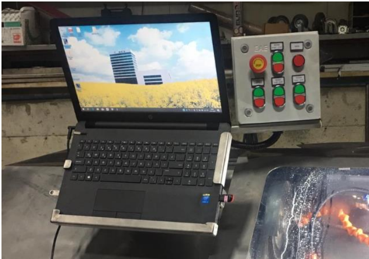
Şekil 3-19. Kontrol ekran ve Panosu
