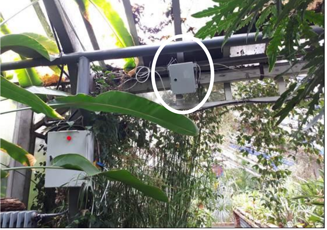
Şekil 3.27. Yağmur ormanı serasında kontrol ünitesinin yerleşimi (19.03.2018)
