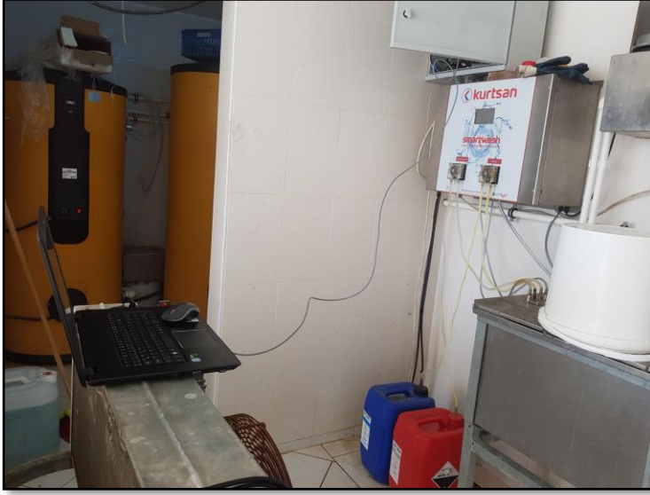
Şekil 3.4. Elektrik enerjisi analizöründen verilerin bilgisayara aktarılması
