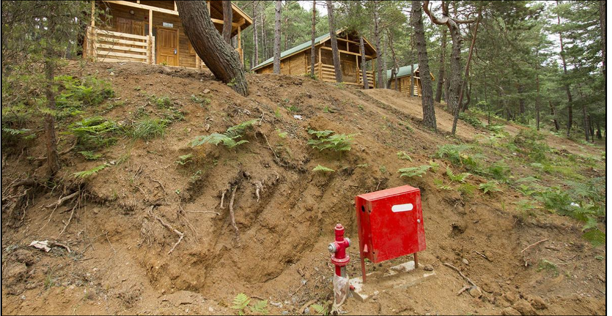
Şekil 4. 19. Yangın Musluğundan Görünüm
