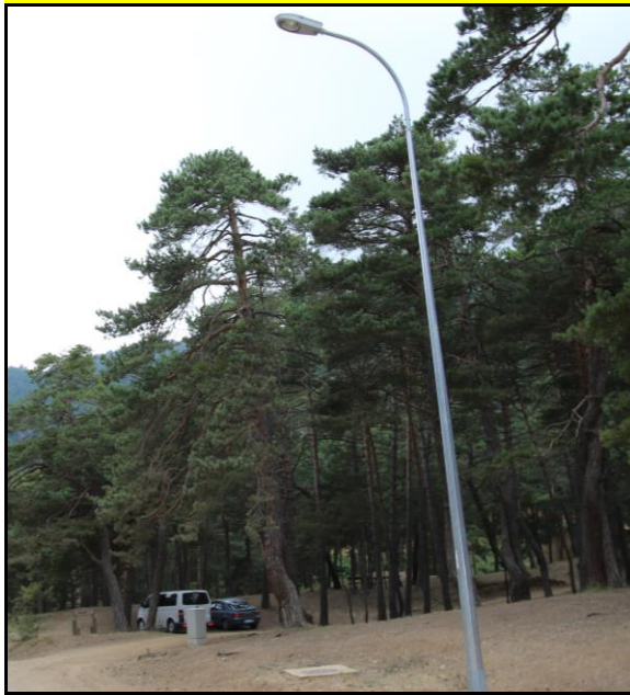
Şekil 4. 14. Araç Yolu Aydınlatması
