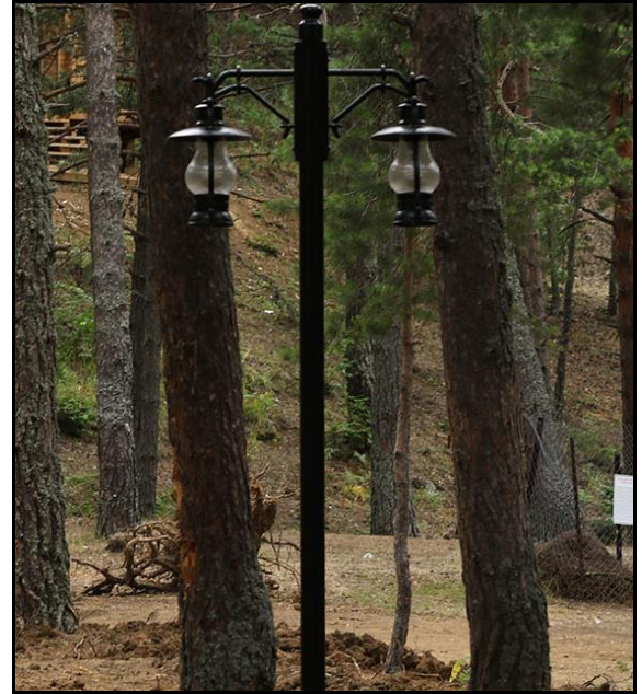
Şekil 4. 15. Yürüyüş yolu aydınlatması
