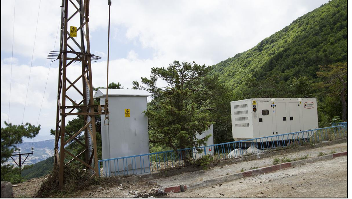
Şekil 4. 20. Trafo ve Jeneratör Görünümü
