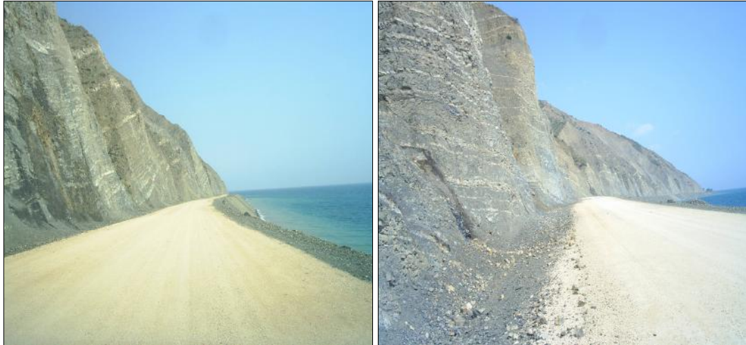
ekil 5.12. Köy yolunun mıcırılı, bozuk kısmından görünüm (Özgün)
